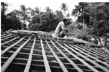
Figura 22 – Telhado para telhas cerâmicas com grande consumo de madeira
