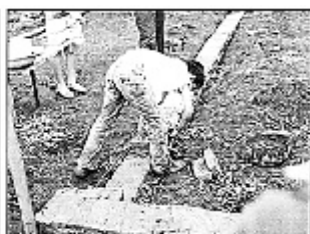
Etapa: Montagem Cadastro: Babilônia - Curitiba/PR A construção começa com a preparação de cimento.
