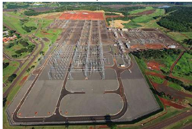
Figura 2. Linhas de Transmissão Elétrica Itaipu-Villa Hayes
