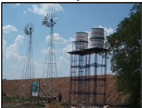
Figura 32. Estrutura de água potável e saneamento em comunidades rurais e indígenas no Paraguai
