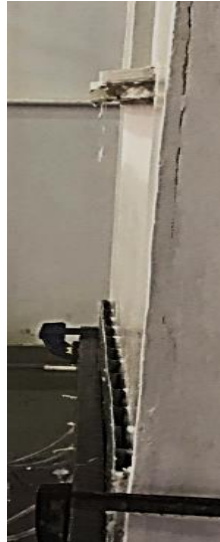
Figura 11 - Fluxo de chuva observado pela lateral da parede no ensaio de chuva dirigida
