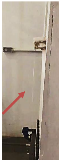
Figura 30 – Foto do fluxo de escoamento da chuva observado pela lateral da parede no ensaio de chuva dirigida
