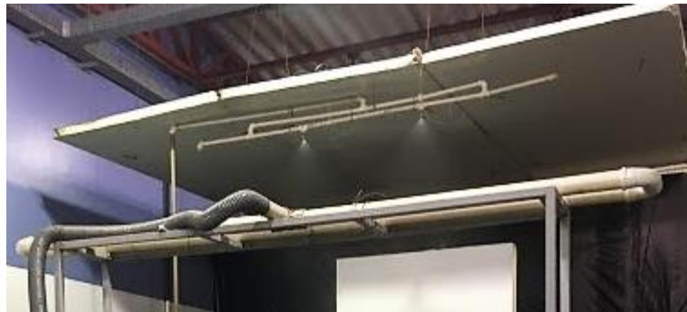
Figura 5 – Sistema de aspersão de água
