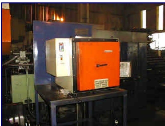
Figura 60 Forno de aquecimento resistivo – Dana DFR
