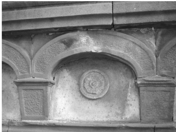
Figura 11 - Feições de deterioração da fachada do museu caracterizadas pela perda de material rochoso, com arredondamento e formação de um relevo áspero.
