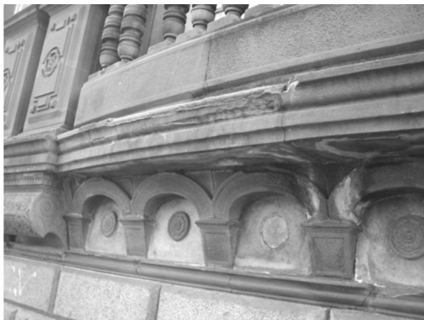
Figura 9 - Feições de deterioração da fachada do Museu Júlio de Castilhos evidenciando a fragmentação e arredondamento de face de bloco de arenito da base da sacada. No canto inferior direito nota-se a deposição de eflorescência salina de cor branca.
