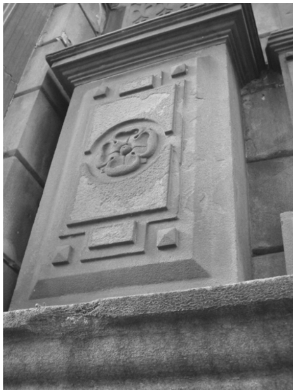
Figura 13 - Detalhe da escamação e da perda de fragmentos (flocos) da porção externa da coluna da fachada do Museu Júlio de Castilhos.
