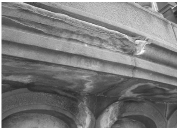
Figura 10 - Escamação de face externa de bloco de arenito com manchas brancas representando eflorescência salina decorrente da precipitação de cimento carbonático hidratado.
