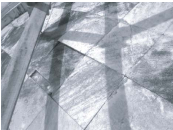
Figura 11 – Detalhe do deslocamento das placas de revestimento.
