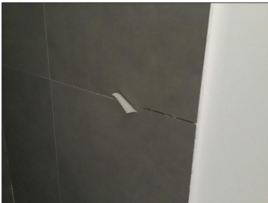
Figura 18 – Falta de rejunte em revestimento cerâmico
