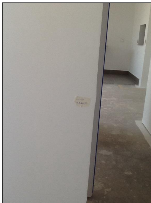
Figura 12 – Parede com ondulação na aresta
