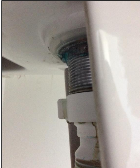
Figura 15 – Válvula de escoamento com vazamento apresentando corrosão
