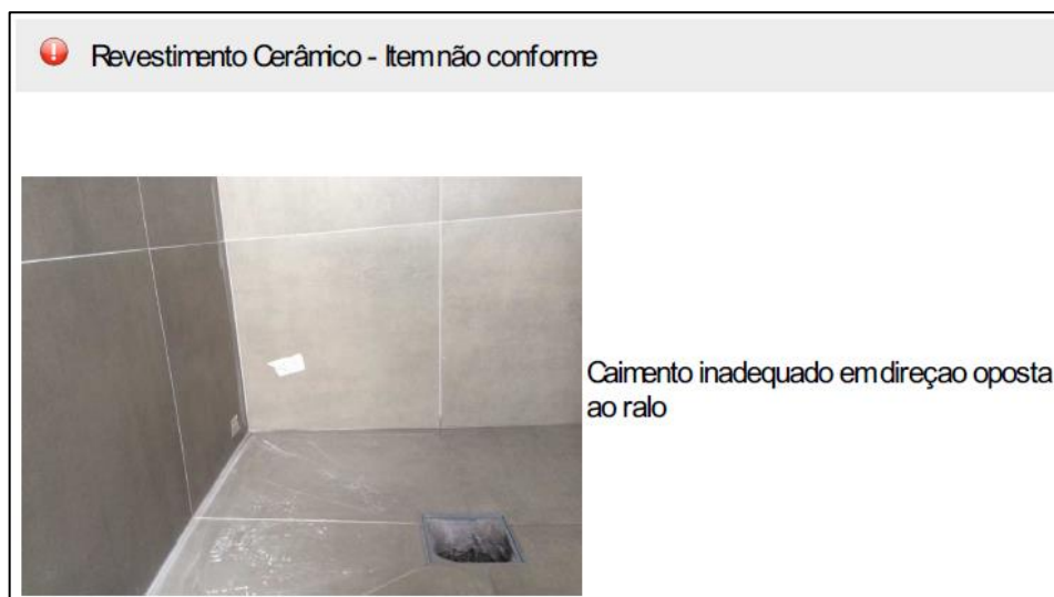
Figura 17 – Revestimento cerâmico em box de banheiro com caimento incorreto
