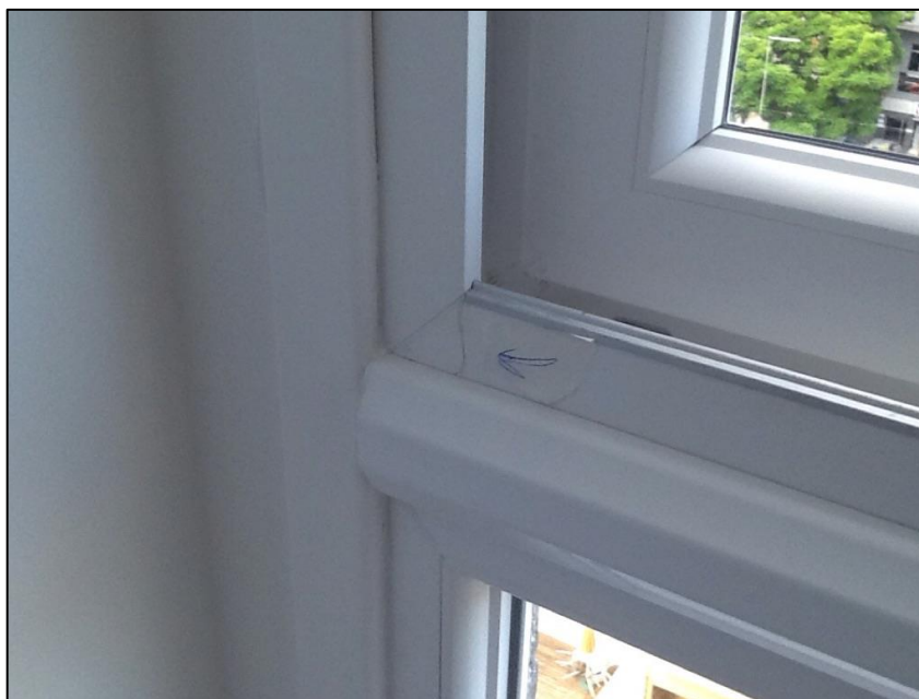
Figura 23 – Trilho da janela de PVC trincado
