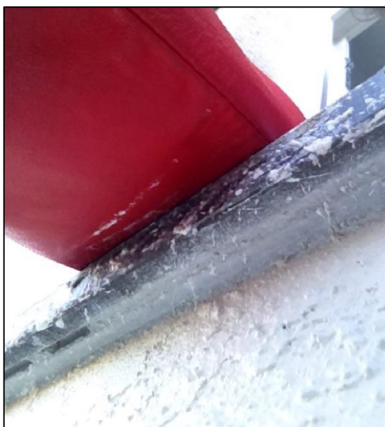
Figura 27 – Pingadeira obstruída pela massa de textura de fachada
