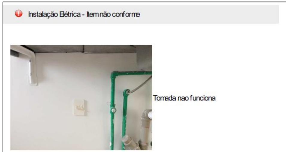
Figura 13 – Exemplo de ocorrência de problema elétrico
