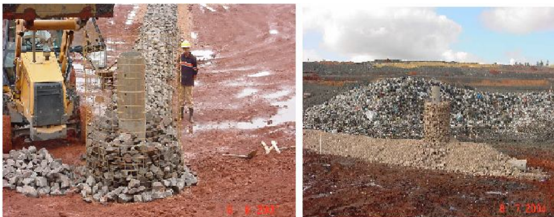
Figura 15 - ARSU - drenagem de gás passiva Fonte SIL soluções ambientais
