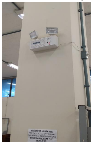
Figura 06 - Bloco autônomo de iluminação instalado.
