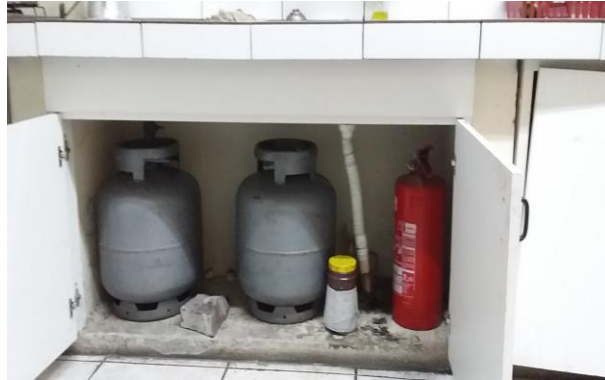
Figura 11 – Botijões de GLP em armário, sem ventilação para o exterior.
