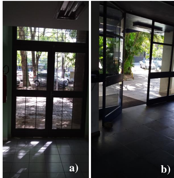
Figura 04 – Saídas de emergência a) sem barras antipânico e b) abrindo para dentro.
