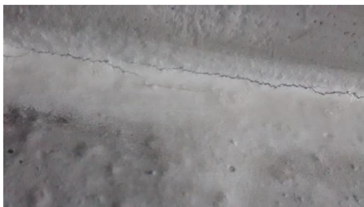
Figura 54 - Aresta sem meia cana apresentando fissura
