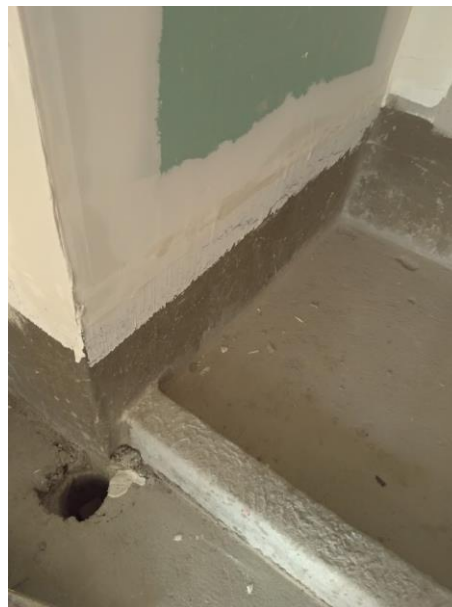
Figura 31 - Impermeabilização no box do banheiro onde há uso de gesso acartonado
