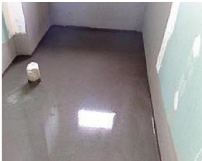
Figura 63 - Teste de estanqueidade
