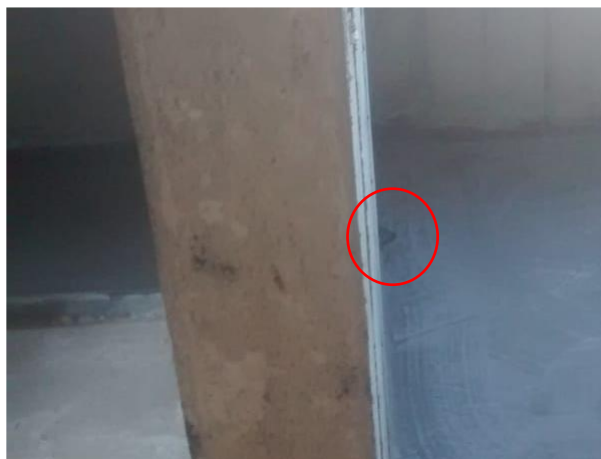
Figura 53 - Vazamento encontrado após o teste de estanqueidade
