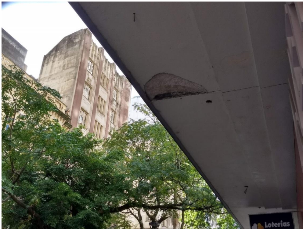
Figura 16 - Marquise com corrosão de armadura e deslocamento do revestimento inferior
