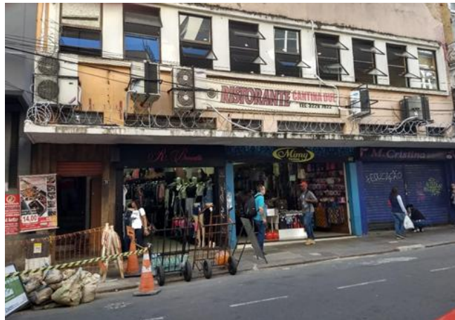
Figura 7 - Marquise com estrutura formada por laje em balanço, sem sobrecargas visíveis
