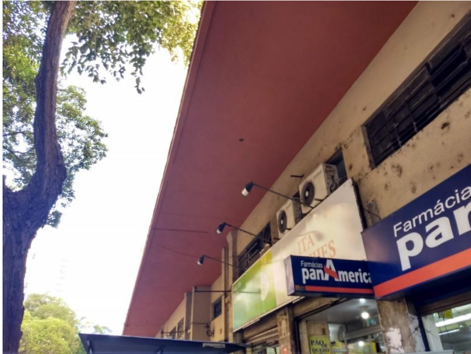
Figura 25 - Marquise com estrutura formada por laje em balanço, sem sinais fissuração ou manchamentos
