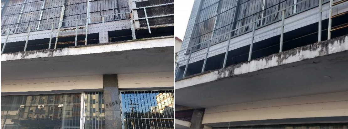
Figura 33 - Marquise com estrutura formada por laje em balanço, com problemas de infiltração e dreno obstruído por vegetação
