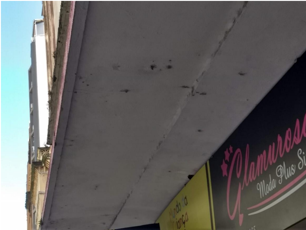
Figura 13 - Marquise com sinais de manchamento
