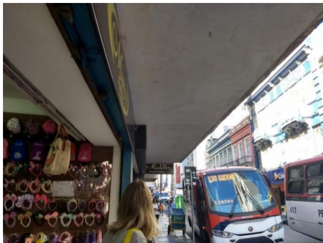
Figura 8 - Marquise com sinais de manchamento e fissuras no revestimento inferior
