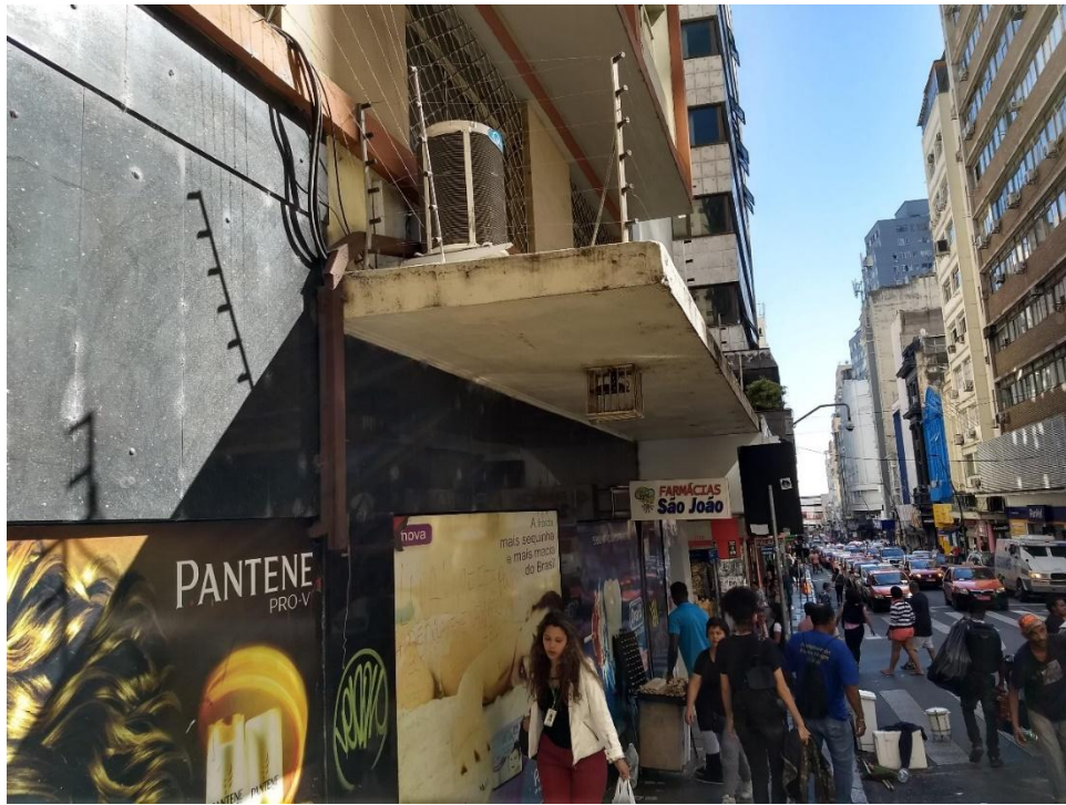
Figura 23 - Marquise com estrutura formada por laje em balanço, sem sinais de sobrecargas. Houve o cuidado de fazer a fixação do condensador do aparelho de ar-condicionado na parede de fachada, utilizando mão-francesa, não gerando desta forma sobrecarga para a marquise
