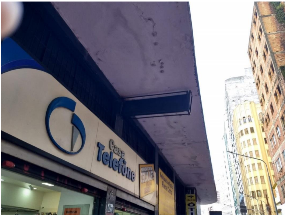
Figura 28 - Marquise com estrutura formada por laje em balanço, sem sobrecargas, com sinais de manchamento e fissuras no revestimento inferior
