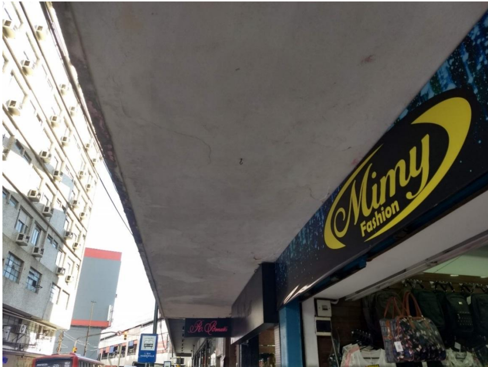
Figura 9 - Marquise com sinais de manchamento e fissuras no revestimento inferior
