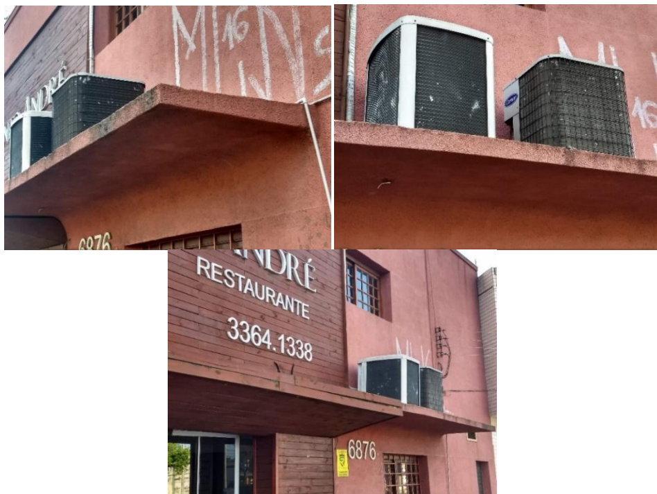
Figura 30 - Marquise com estrutura formada por laje em balanço, com sobrecarga causada por máquinas condensadoras de ar condicionado apoiadas diretamente na estrutura
