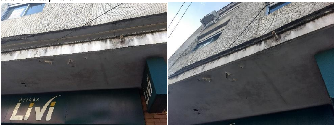
Figura 35 - Marquise com estrutura formada por laje em balanço, com problemas de infiltração e descolamento da pintura
