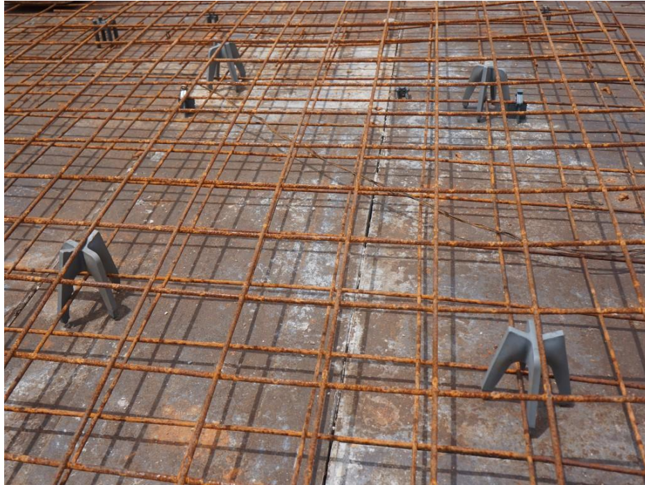
Figura 4 - Espaçadores plásticos para posicionamento da armadura superior de uma laje (armadura negativa). O tráfego de operários e equipamentos diretamente sobre essa armadura pode causar grandes alterações no seu posicionamento, com grandes implicações na eficiência da armadura e potencialmente na estabilidade estrutural da laje
