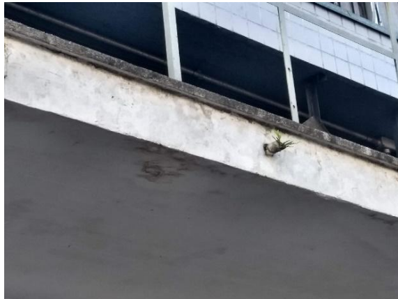
Figura 34 - Marquise com estrutura formada por laje em balanço, com problemas de infiltração e dreno obstruído por vegetação.
