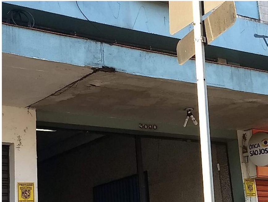
Figura 31 - Marquise com estrutura formada por laje em balanço, com problemas de infiltração na junta
