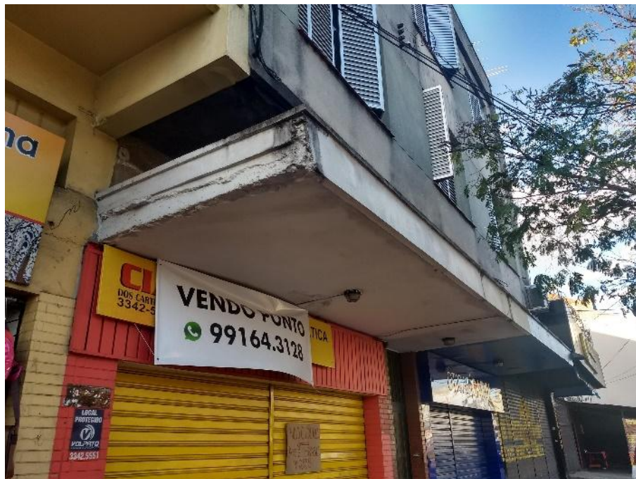
Figura 32 - Marquise com estrutura formada por laje em balanço, com deslocamento do revestimento lateral e inferior.
