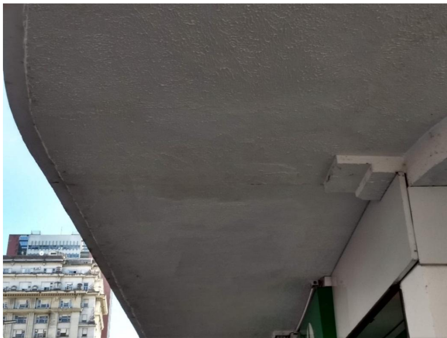
Figura 18 - Marquise com indícios de descolamento de revestimento na parte inferior, já reparado
