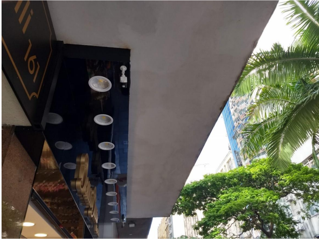
Figura 11 - Marquise com sinais de manchamento e fissuras no revestimento inferior
