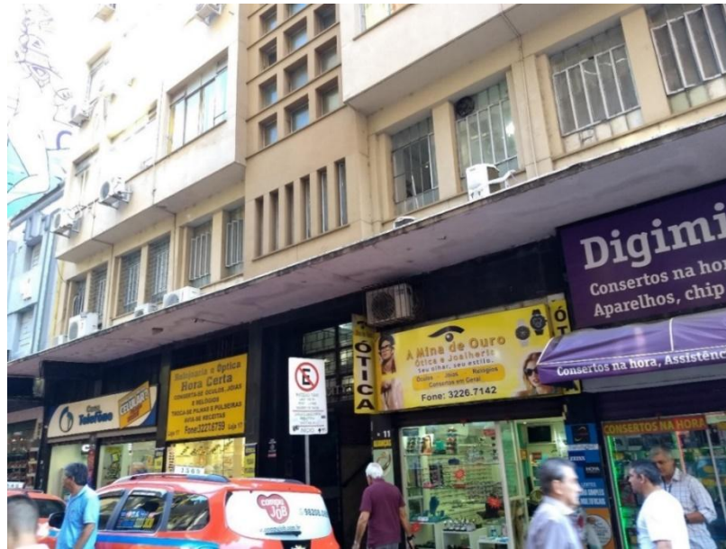
Figura 29 - Marquise com estrutura formada por laje em balanço, sem sobrecargas, com sinais de manchamento e fissuras no revestimento inferior
