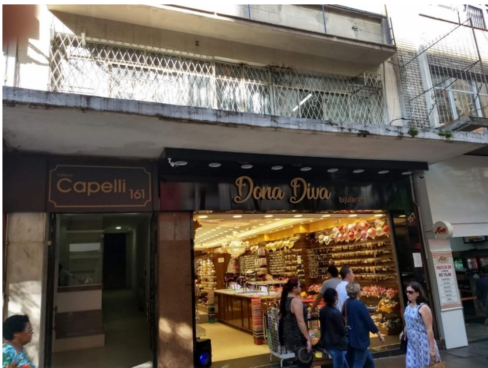
Figura 10 - Marquise com estrutura formada por laje em balanço, sem sobrecargas, com sinais de manchamento e fissuras no revestimento inferior
