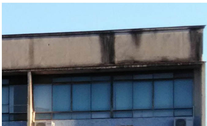
Figura 9 – Manchas na parte superior da fachada da EE Nova
