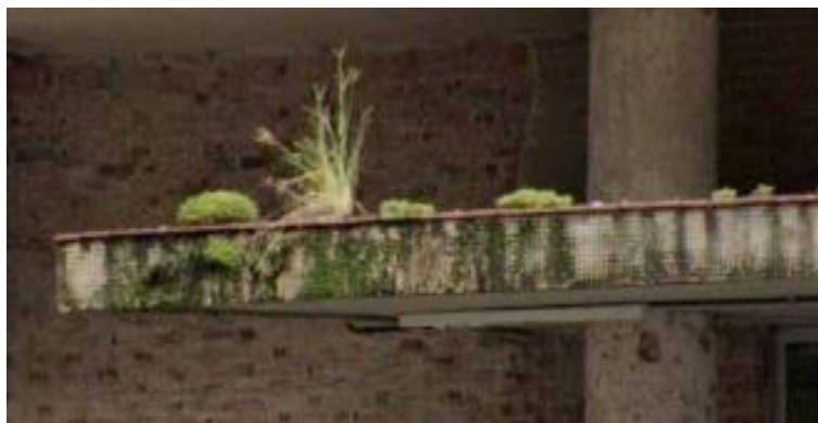
Figura 4 – Biodeterioração por plantas na EE Nova
