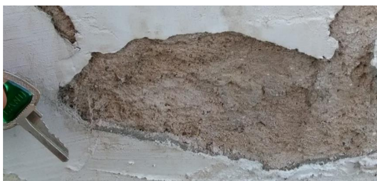
Figura 5 – Desagregação do revestimento na EE Nova
