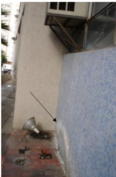
Figura 7 – Eflorescência na EE Nova
