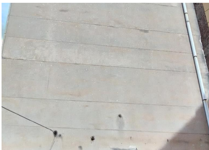
Figura 11 – Indícios de umidade manifestada por meio de manchas na EE Nova
