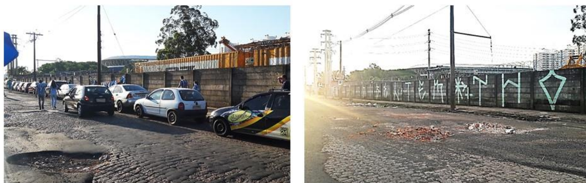
Figura 51 – Infraestrutura – Buracos na via da Rua José Pedro Boéssio.
