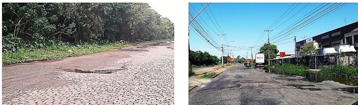
Figura 52 – Infraestrutura – Buracos na via da Rua José Pedro Boéssio e alagamentos.
