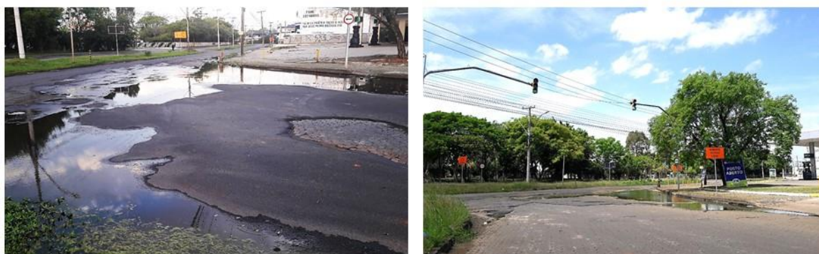
Figura 53 – Infraestrutura – Buracos, esgoto e água parada: constante no entroncamento entre as ruas José Pedro Boéssio e José Aloísio Filho.
