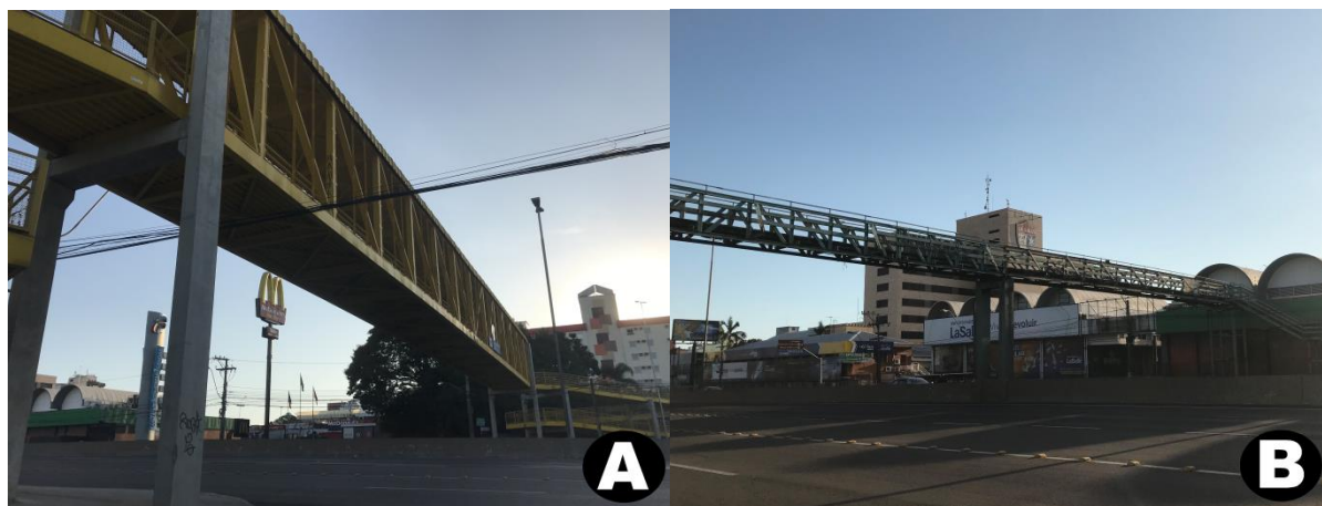
Figura 12: A : Nova passarela – B : Passarela que liga os bairros Centro e Marechal Rondon, mas que atualmente está desativada - Fonte: Dayara Silva (Março, 2020)
