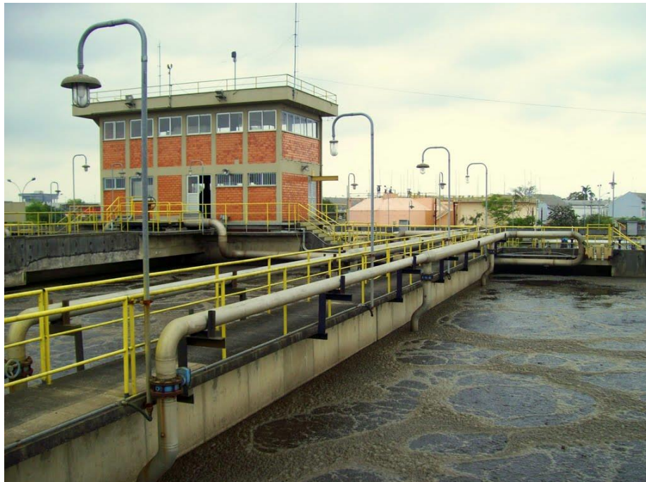
Figura 6 - ETE São João-Navegantes: Lodos Ativados
