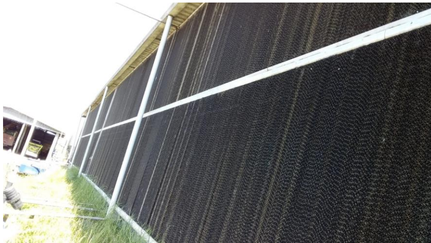
Figura 8 - Vista externa da parede vazada com fluxo de água do galpão de confinamento
