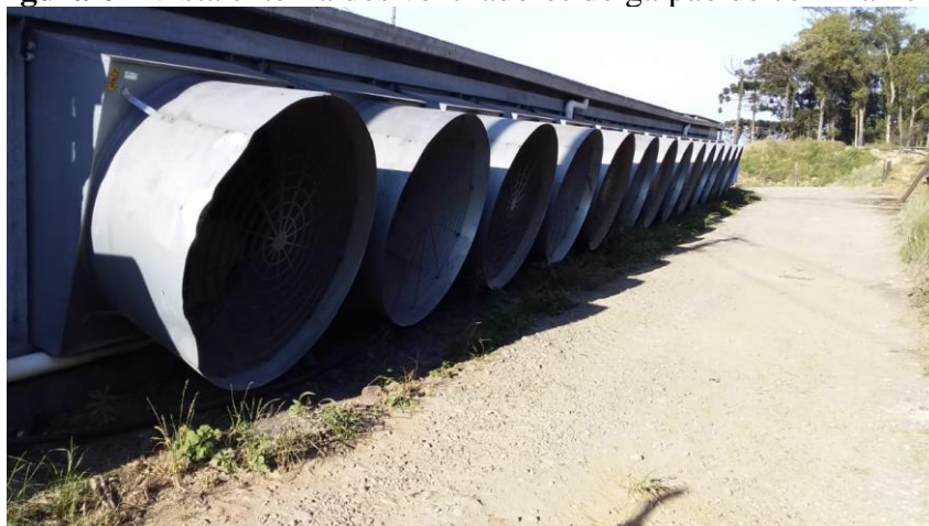
Figura 6 - Vista externa dos ventiladores do galpão de confinamento
