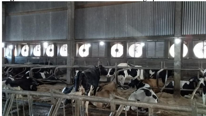
Figura 5 - Vista interna dos ventiladores do galpão de confinamento
