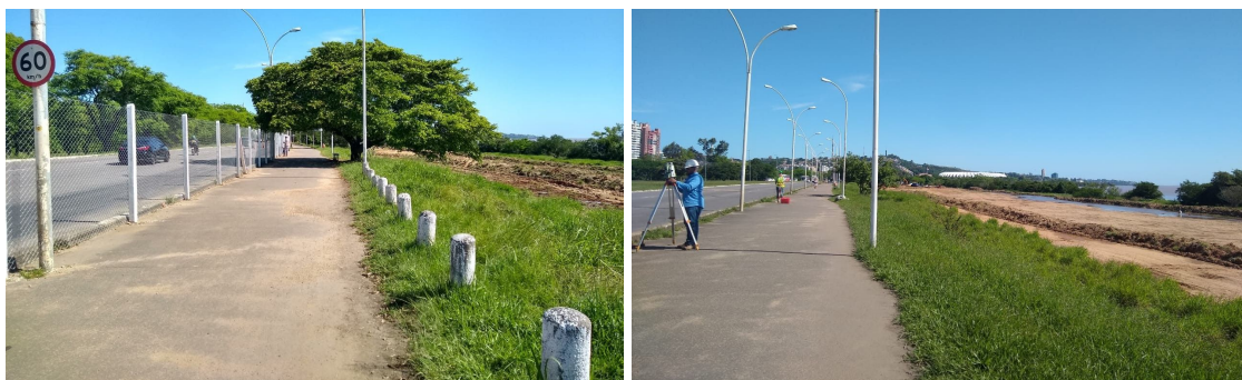
Figura 18 e 19. Na foto da esquerda, parte do trecho já cercado para obras. Na foto da direita, técnico realiza levantamento topográfico da área e terreno em processo de terraplanagem. Foto: Manoela Rodrigues
