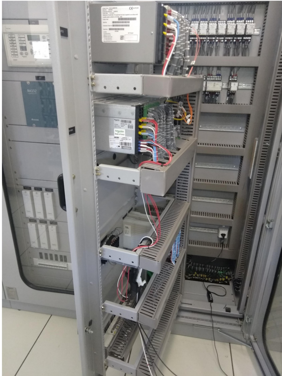
Figura 18 – Painel de proteção em que foi instalado o equipamento de medição.
