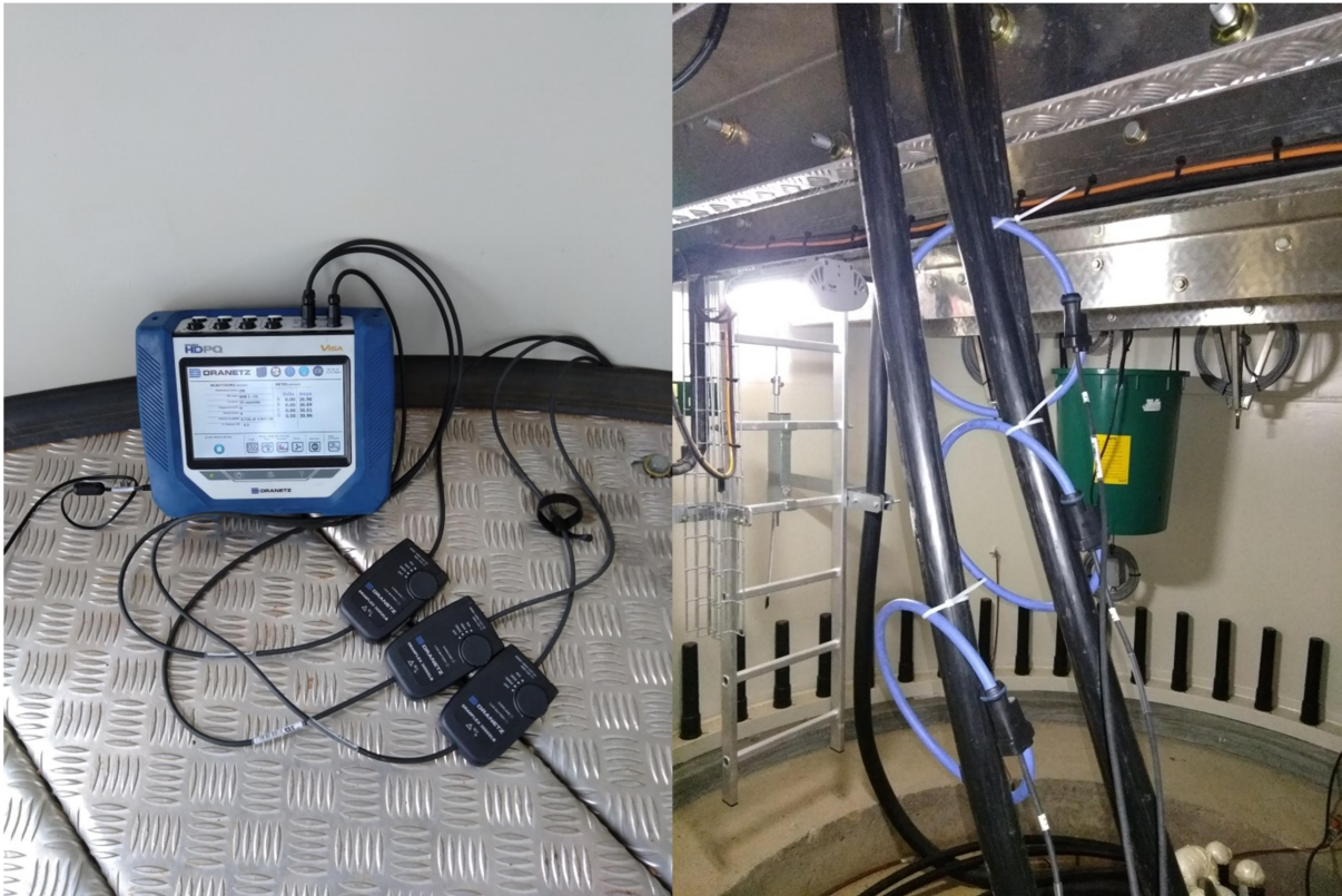
Figura 13 – Coleta de correntes harmônicas em um dos aerogeradores dos Parques Eólicos.
