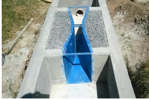
Figura 6.5 – Referência de calha Parshall
