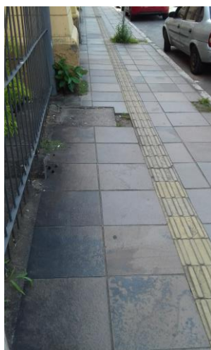
Figura 83 - Lajota faltando na calçada
