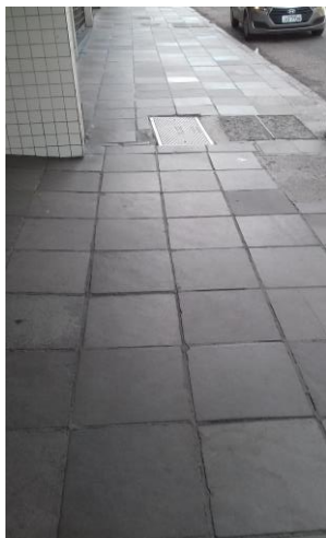
Figura 54 - Calçada Avenida João Pessoa
