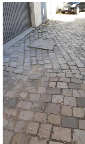
Figura 64 – Tapa caixa de inspeção
