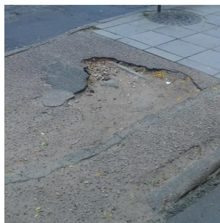
Figura 47 - Detalhe deslocamento do concreto
