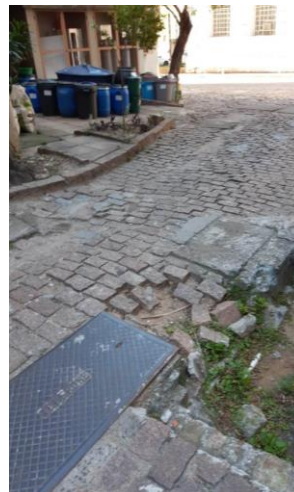
Figura 30 - Detalhe pedras soltas
