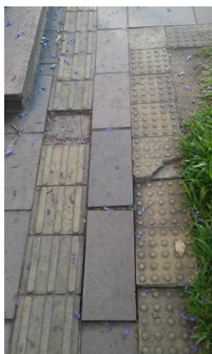
Figura 89 - Detalhe desníveis nas lajotas
