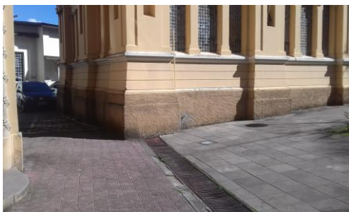
Figura 72 – Faixa de grelhas
