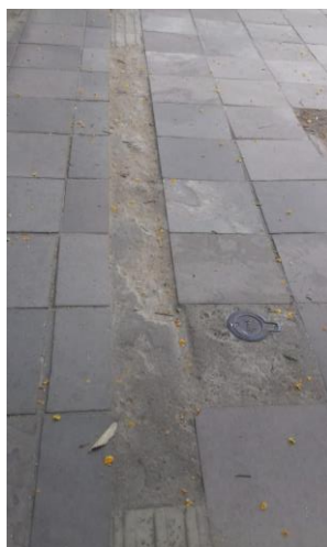
Figura 42 - Detalhe trecho do piso tátil faltando lajotas
