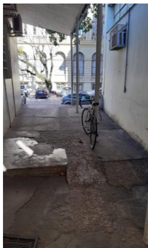
Figura 109 – Patamar de 14 cm e obstáculos bloqueando a passagem
