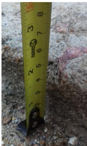
Figura 31 - Detalhe tampa da caixa de inspeção com desnível
