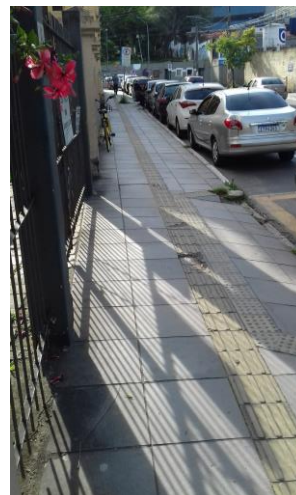
Figura 82 - Falha no piso tátil
