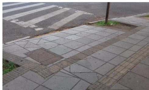
Figura 93 – Piso tátil de alerta nas bordas da rampa
