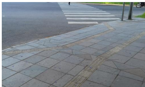
Figura 91 – Rebaixo de guia sem ligação com o trecho principal do piso tátil
