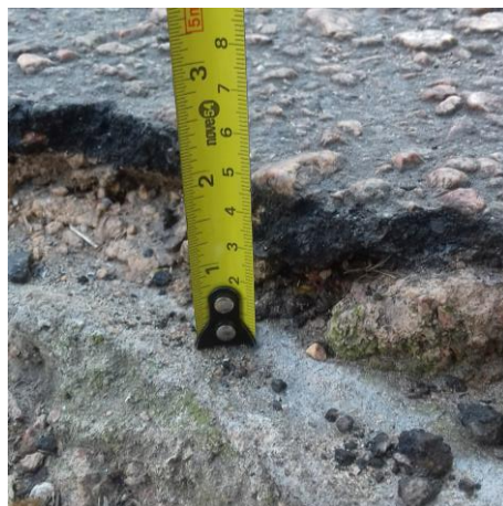
Figura 48 - Detalhe desnível do buraco
