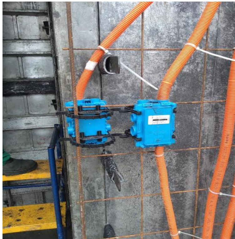
Figura 7: Instalações elétricas na parede
