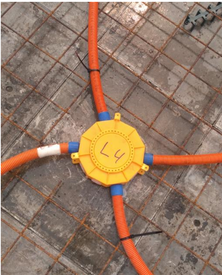
Figura 105: Caixas elétricas fixadas nas tampas
