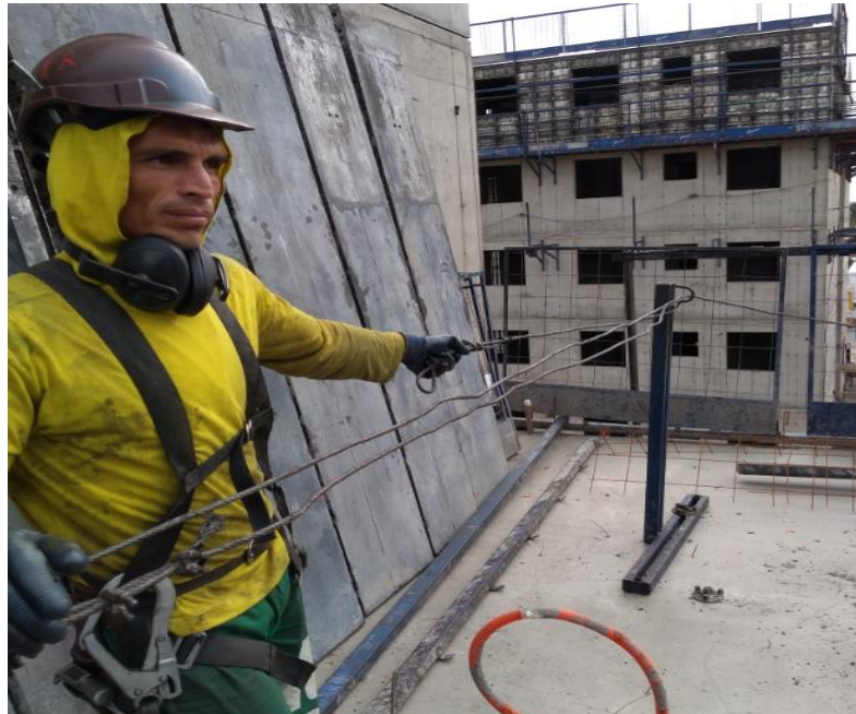
Figura 90: Montador passando o cabo de linha de vida pela alça dos T's
