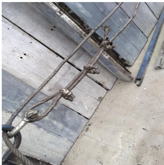
Figura 52: Cabos da linha de vida fixados com 3 cliques
