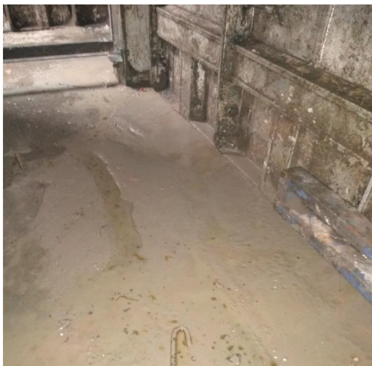
Figura 117: Vazamento de nata de concreto
