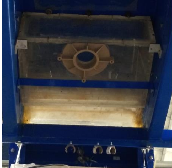
Figura 32 – Câmara de ar instalada abaixo da ogiva, sem tubulação
