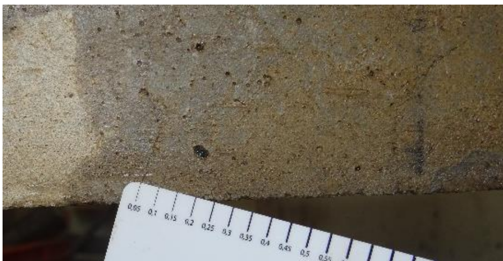
Figura 56 - Medição da abertura de fissura da viga V15FA.
