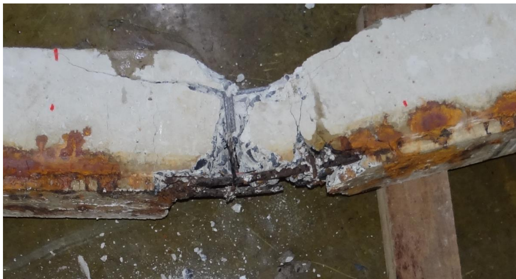
Figura 49 - Rompimento da armadura longitudinal no terço médio da viga V06CO.
