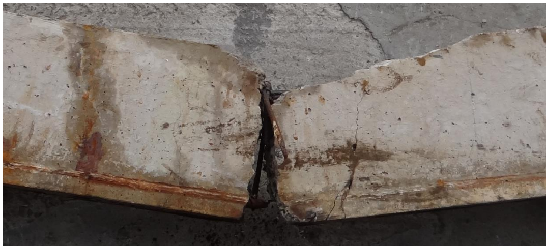
Figura 48 - Rompimento da armadura longitudinal no terço médio da viga V12CO.
