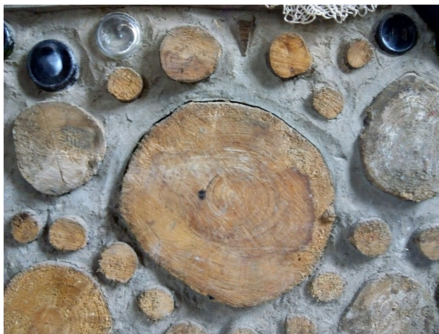
Figura 62: Fresta entre o toco e a argamassa devido à retração da madeira. (Foto de arquivo pessoal)
