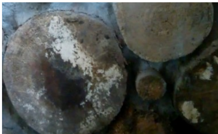
Figura 64: Mofo onde a parede recebe chuva não recebe insolação. (Foto de arquivo pessoal)
