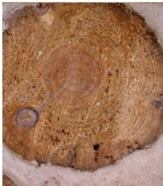
Figura 60: Deterioração causada por dois anos de abandono ao relento. (Foto de arquivo pessoal).
