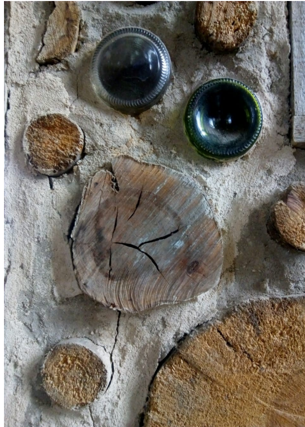
Figura 63: Rachaduras em torno de um toco que expandiu. As fissuras foram cobertas com argamassa. (Foto de arquivo pessoal)
