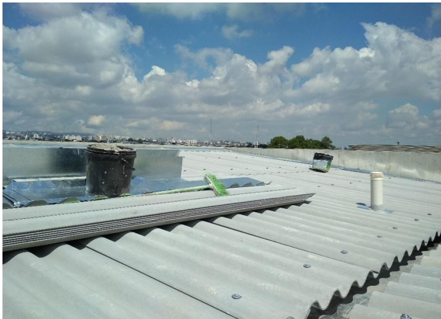
Figura 44 - Falta de desmobilização na atividade de telhado. (Fonte: autora)
