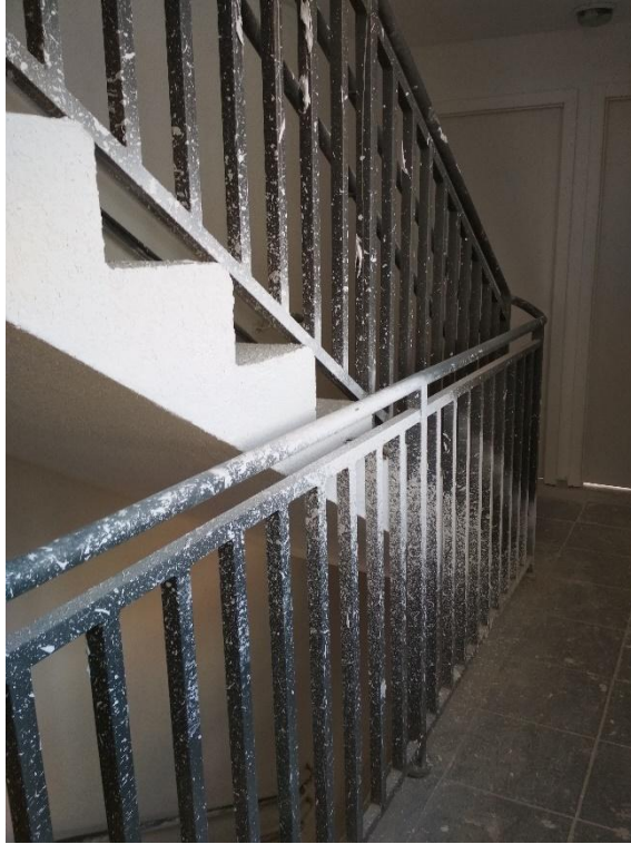
Figura 33 - Falta de desmobilização para liberação da pintura do guarda-corpo. (Fonte: autora)
