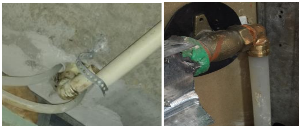
Figura 42 – Chamados de assistência técnica para vazamentos de esgoto e de água
