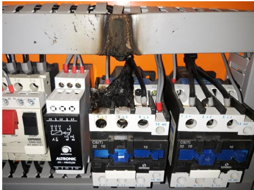
Figura 33 – Quadro Elétrico em Curto
