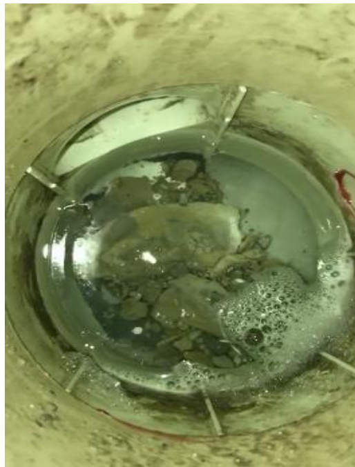
Figura 18 – Ralo obstruído com resíduos de obra
