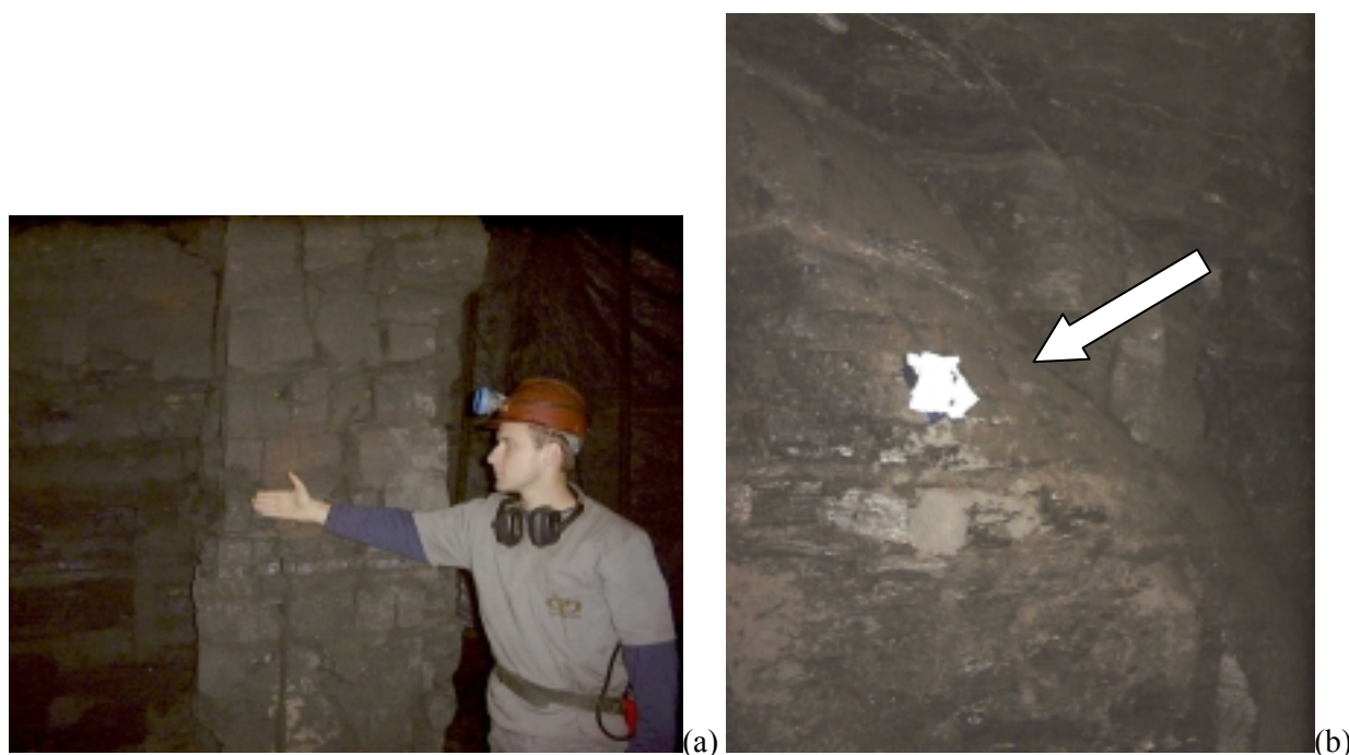
Figura 1.1 – Ruptura em pilares na camada Bonito devido a presença de descontinuidades. (a) Descontinuidades paralelas a face do pilar. (b) Descontinuidade com mergulho oblíquo que corta o pilar, provocando o caimento de blocos (figuras sem escala).
