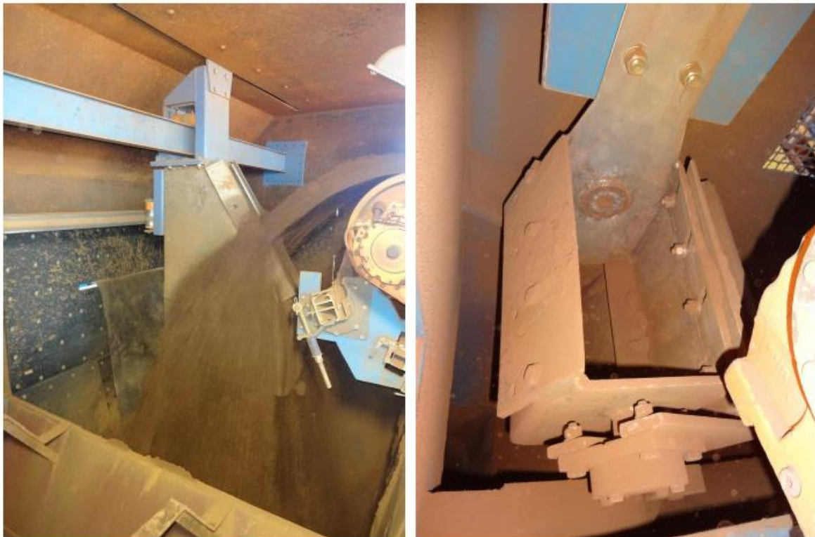
Figura 4-1: Amostradores corta-fluxo primário e secundário na torre de amostragem da CBMM
