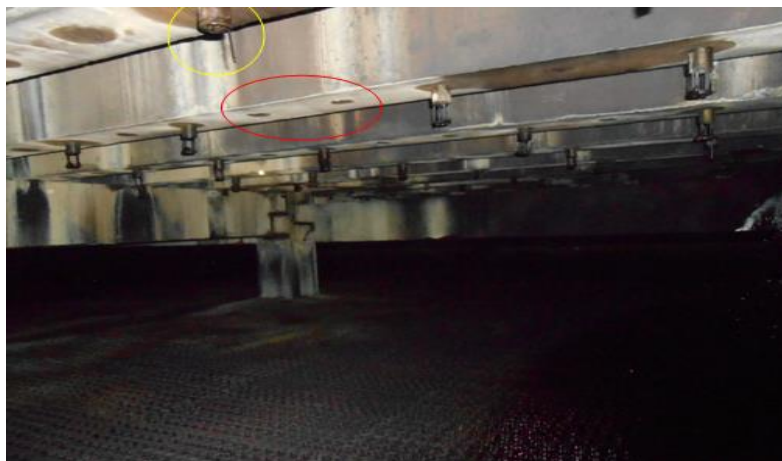
Figura 19 - Ausência (em vermelho) e danos (em amarelo) nos bicos distribuidores
