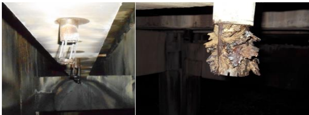
Figura 20 - Quebra (à esquerda) e entupimento (à direita) de bicos distribuidores
