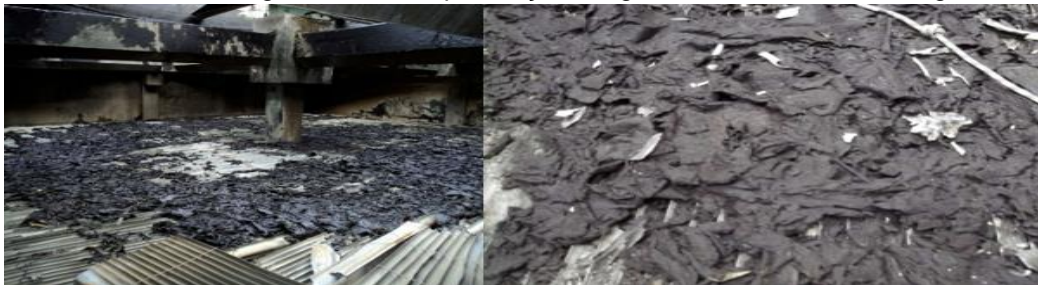
Figura 22 - Forte presença de algas sobre o eliminador de gotas
