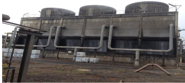
Figura 14 - Ramais de recebimento de água de retorno bloqueando as entradas de ar
