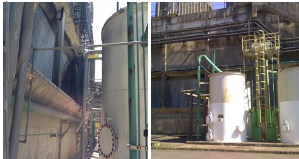
Figura 15 - Filtro instalado em frente à entrada de ar da célula A
