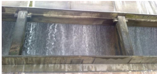
Figura 16 - Visíveis caminhos preferenciais na saída da torre de resfriamento
