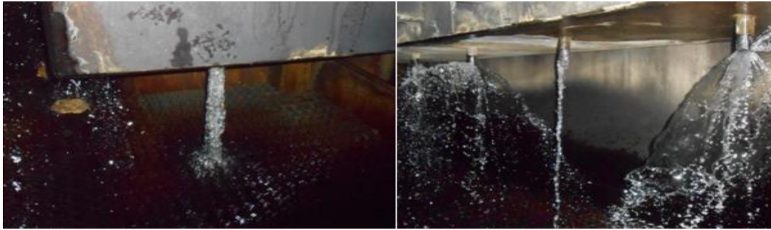
Figura 21 - Fluxo de água refrigerada sem distribuição, devido quebra de bicos
