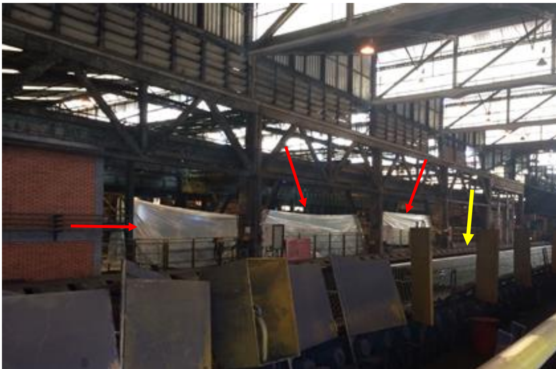
Figura 28 – Região em que as lonas foram colocadas, indicadas pelas setas vermelhas. O leito de resfriamento está indicado pela seta amarela.
