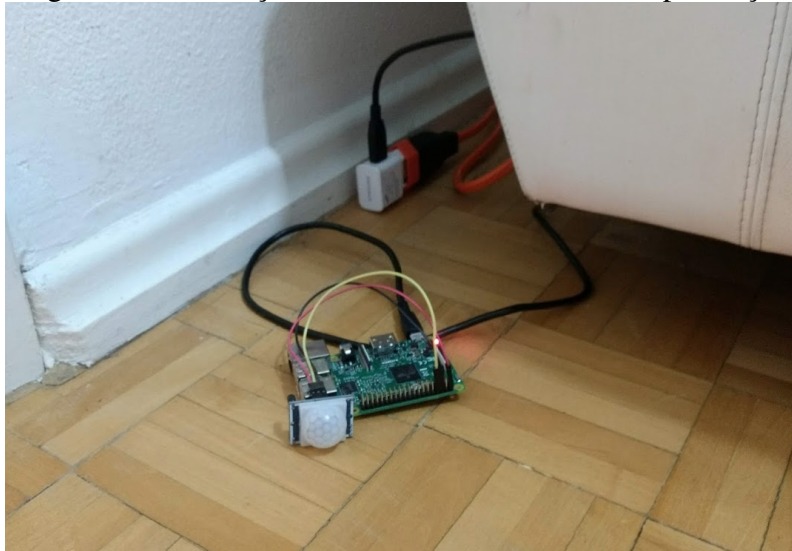
Figura 5.5: Instalação do sensor infravermelho de presença.
