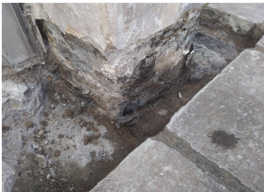
Figura 8 - Problemas de impermeabilização junto ao pilar externo
