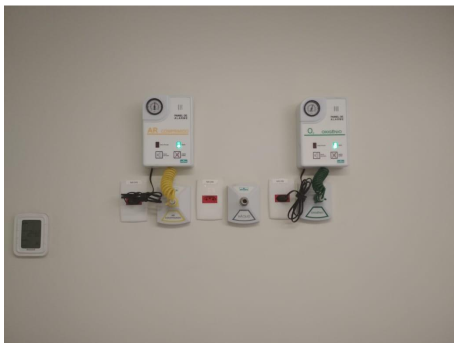
Figura 21 - Painel de gases medicinais executado na recepção
