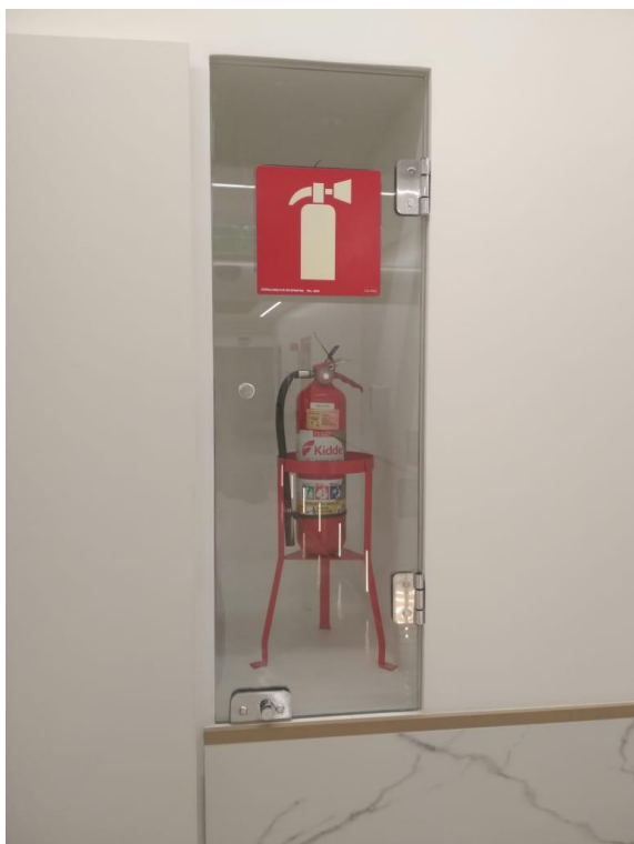
Figura 27 - Nicho dos extintores modificado
