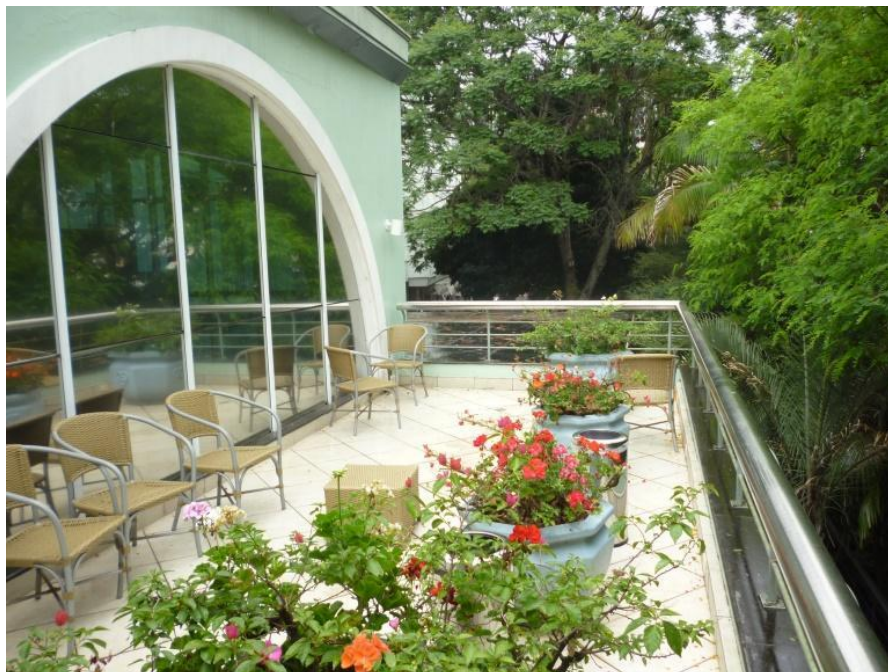
Figura 31 - Esquadria em arco do terraço 1 que foi removido o algeroz
