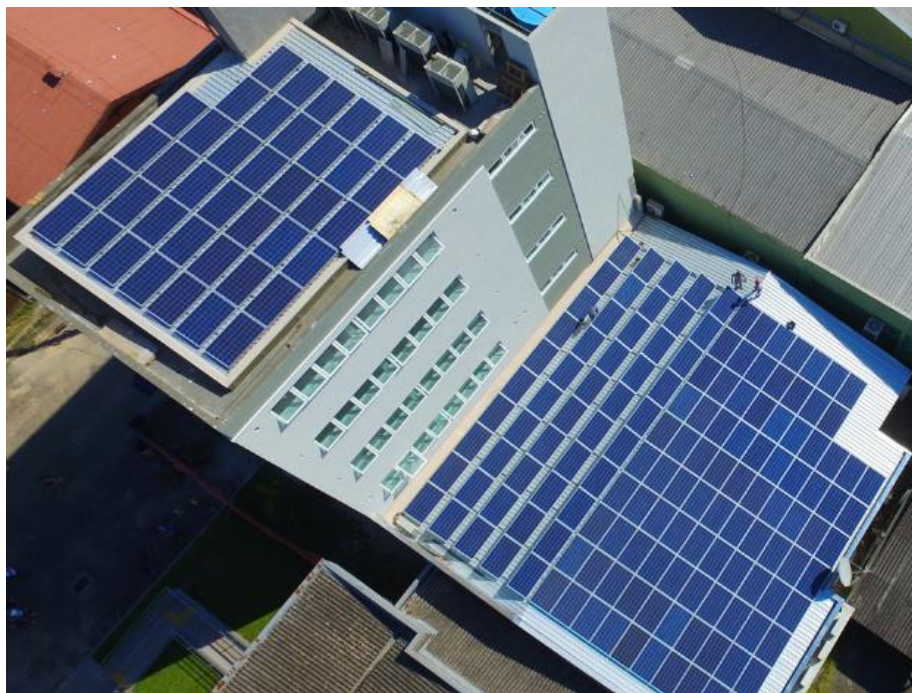
Figura 21: SFCR instalado no município de Três Coroas/RS já em operação (Fonte: EPI energia)
