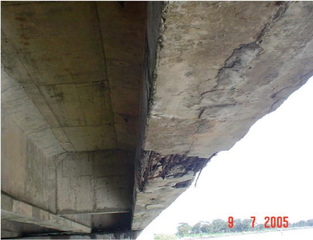
Foto 1 – Detalhe da armadura no centro do vão, exposta e corroída. A bainha de um dos cabos de protensão já foi toda consumida, e as cordoalhas estão aparentes e rompidas.
