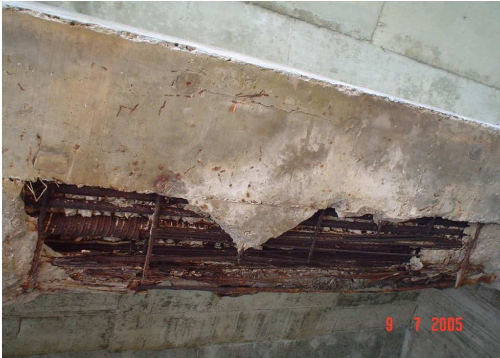
Foto 5 – Armaduras passivas e ativas corroídas, bem como o estribo e a bainha da armadura de protensão.
