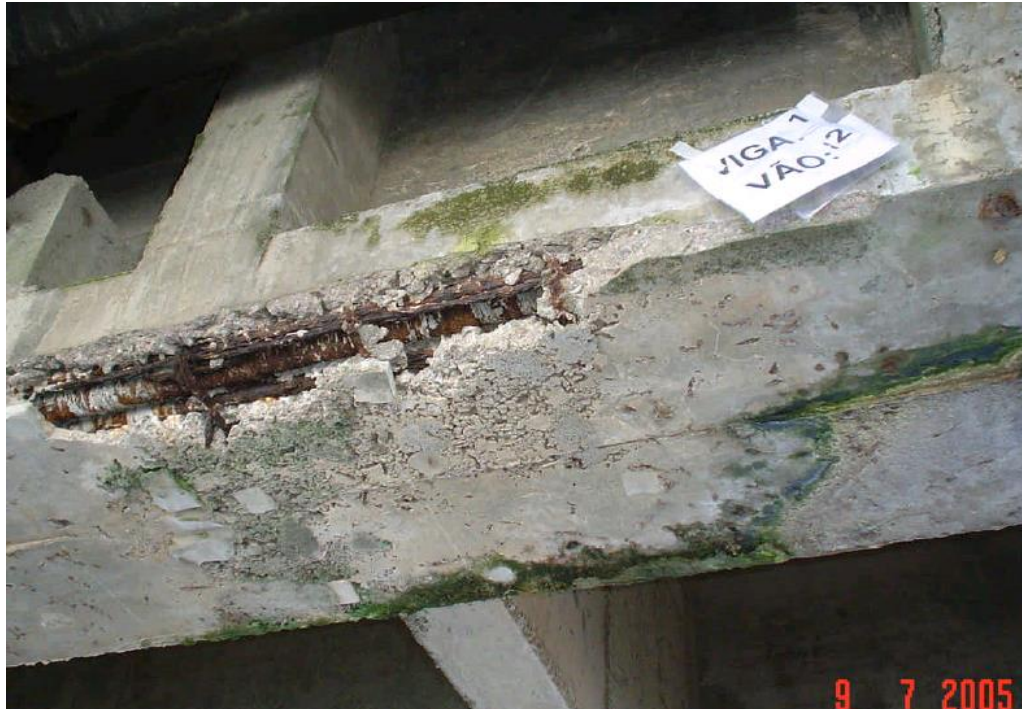
Foto 2 – Detalhe de uma região com falha de concretagem, com concreto segregado que permite a corrosão das armaduras e exposição das bainhas de protensão.
