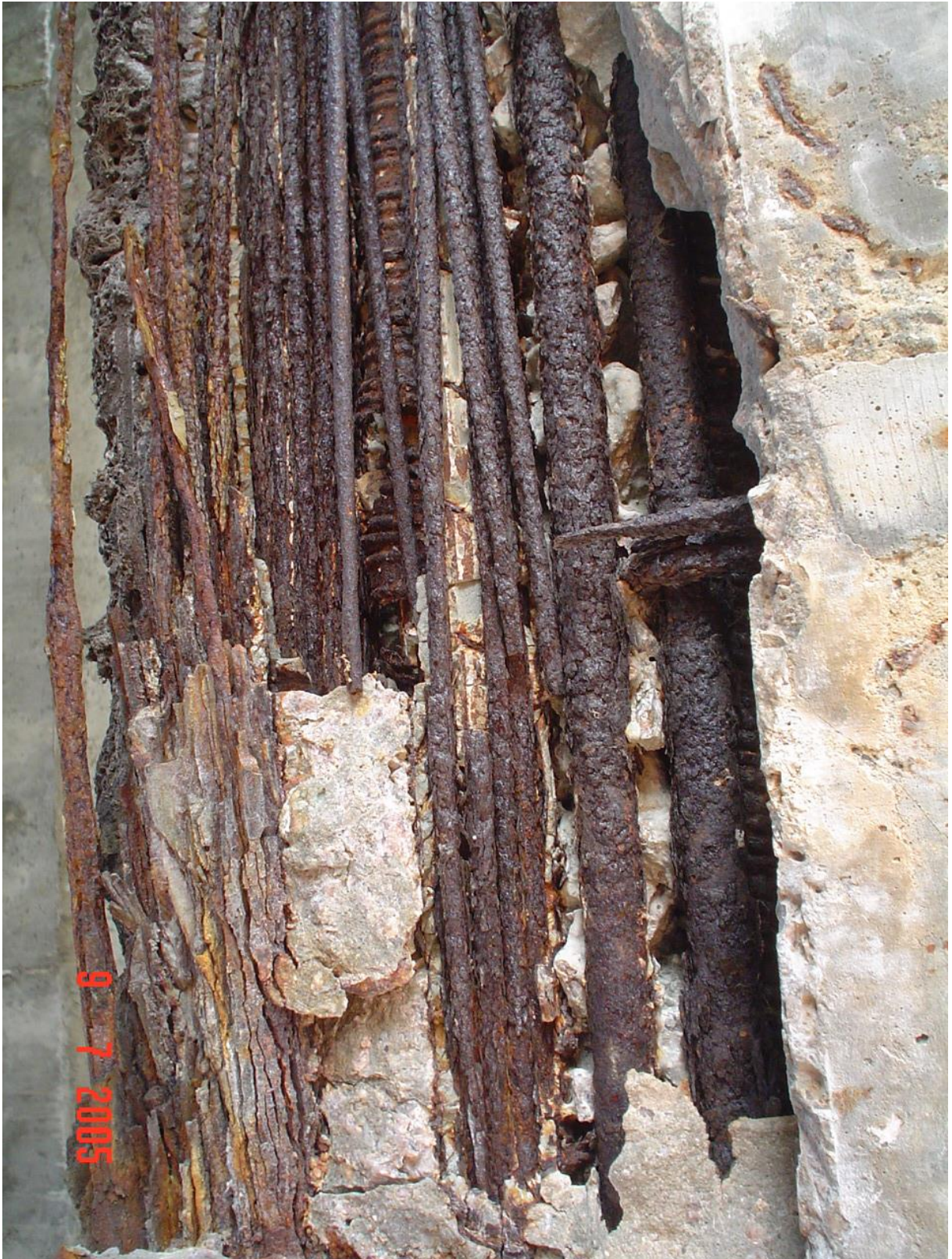
Foto 8 – Armaduras passivas e ativas corroídas
