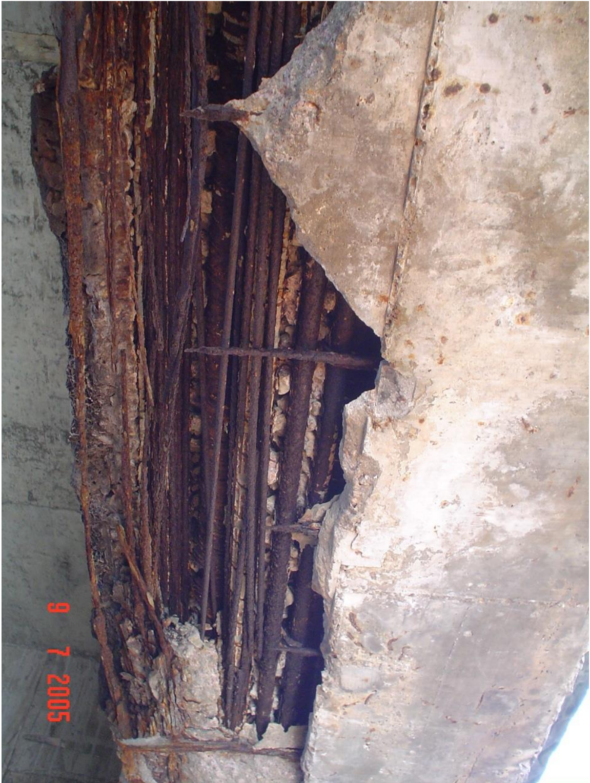
Foto 6 – Armaduras passivas e ativas corroídas, bem como o estribo e a bainha da armadura de protensão.
