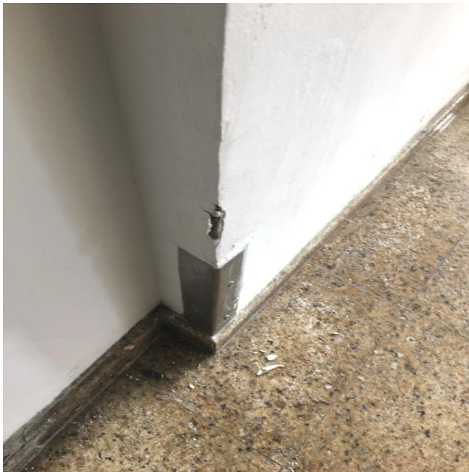
Figura 8 – Parede de alvenaria danificada
