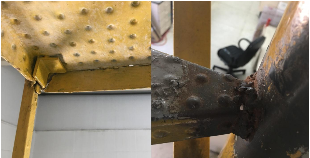
Figura 10 – Problemas em escada metálica
