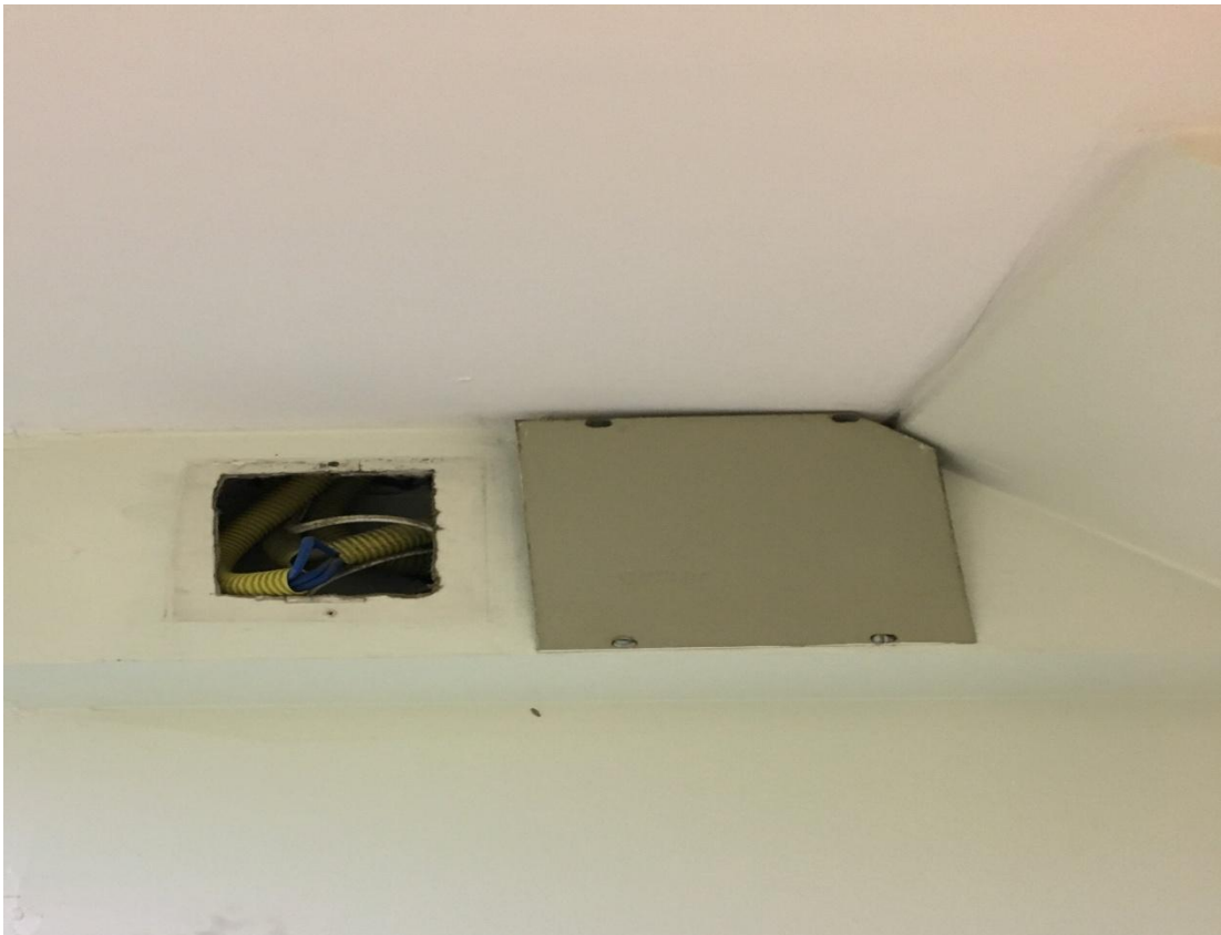
Figura 7 – Caixa de passagem elétrica aberta
