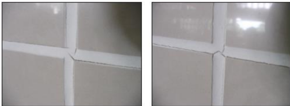
Figura 8 - Fissuras em argamassas para rejuntamento
