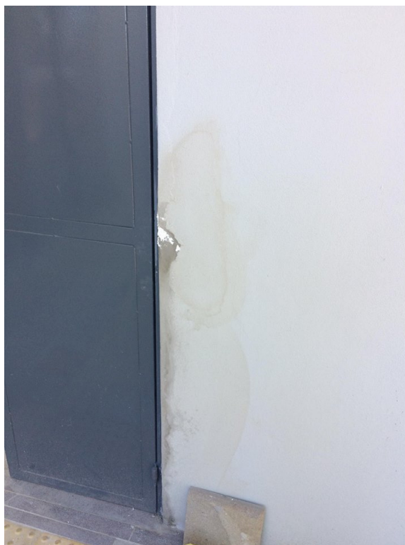
Figura 26 - Foto Falha no Acabamento das Golas das Portas
