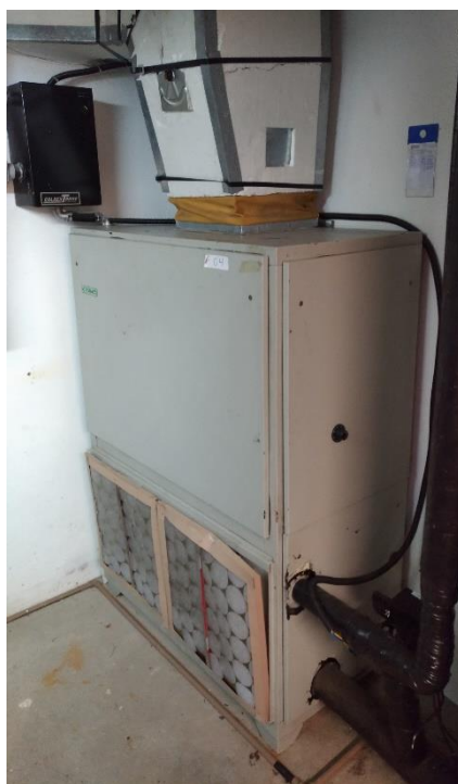
Figura 16 - Fancoil de gabinete, presente no segundo pavimento
