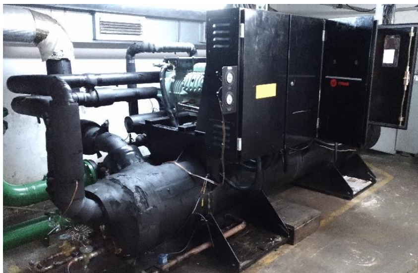
Figura 14 - Central de água gelada existente no prédio
