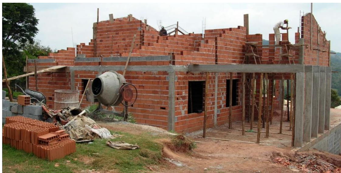
Figura 15 – Sistema convencional de construção com estrutura de concreto armado e alvenaria de vedação
