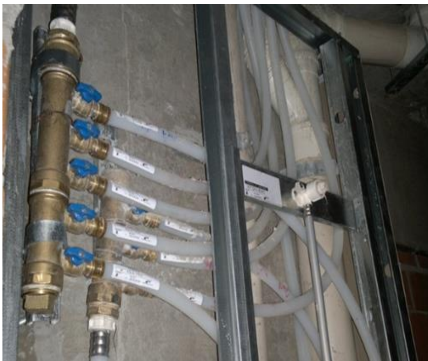
Figura 13 – Instalação hidráulica com tubos PEX
