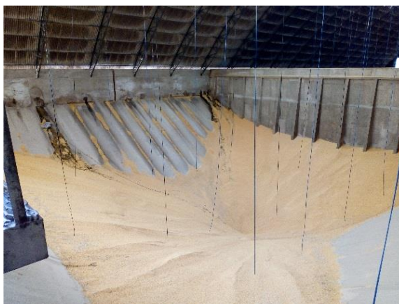
Figura 10 - Infiltrações no armazém da unidade do município de Chapadão do Céu, (2018).
