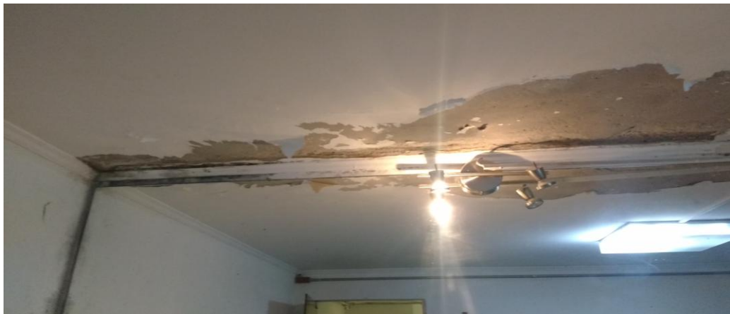
Figura 47 – Manifestações patológicas devido à entrada de água da chuva no térreo
