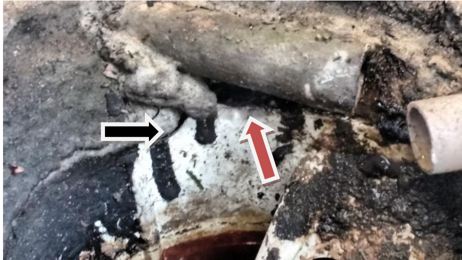
Figura 53 – Localização dos problemas no ralo
