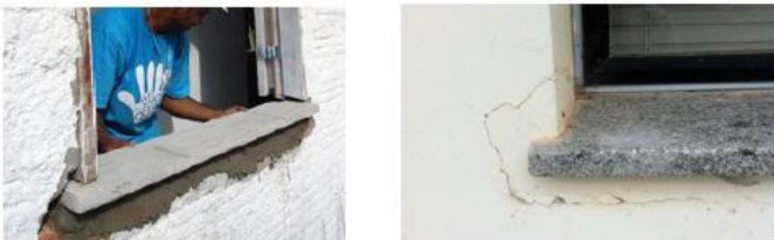
Figura 15 – Fissuras por retração devido camadas excessivas de argamassa em peitoril
