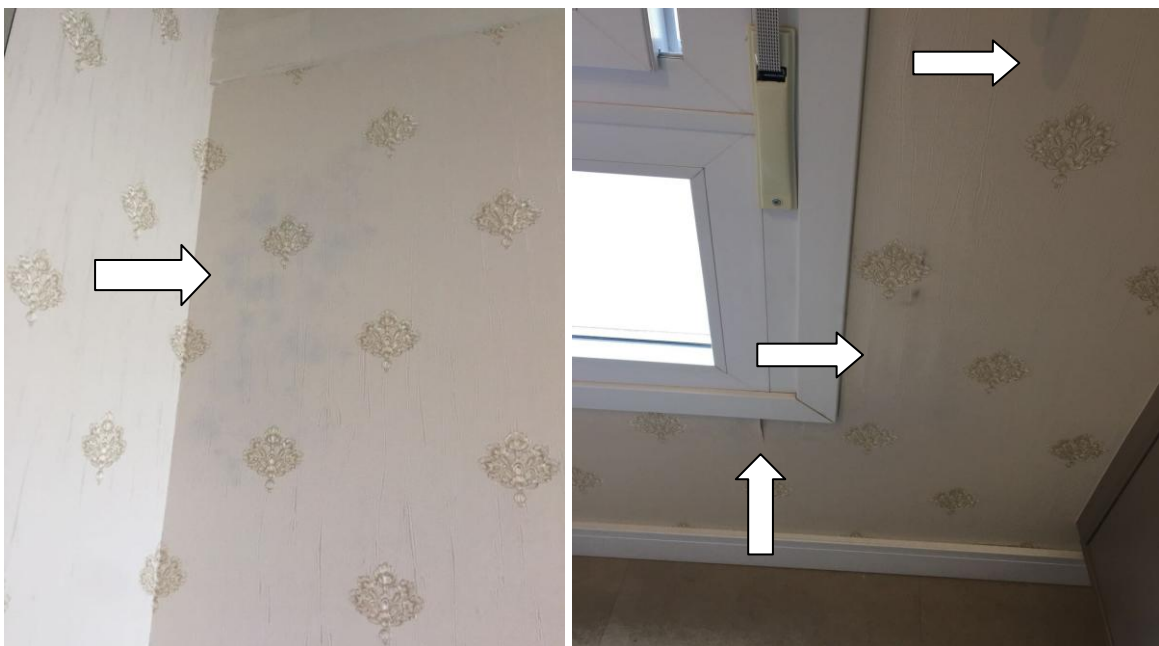
Figura 32 – Mofo devido umidade em papel de parede
