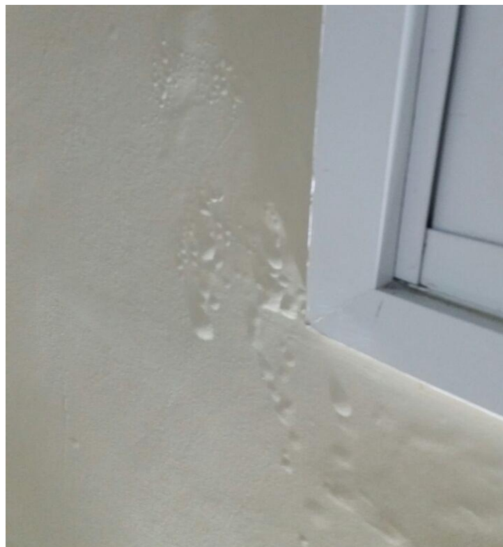
Figura 22 – Umidade em pintura interna
