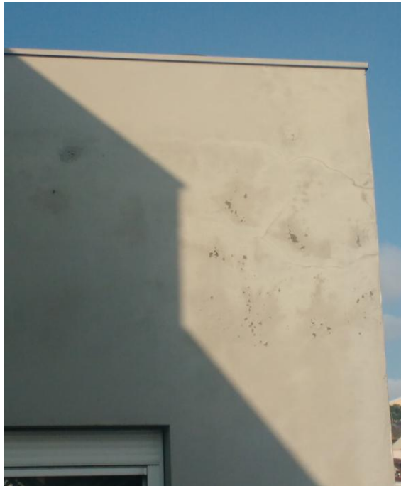
Figura 31 – Fissuras em fachada
