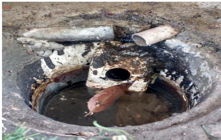
Figura 52 – Ralo com problemas de estanqueidade
