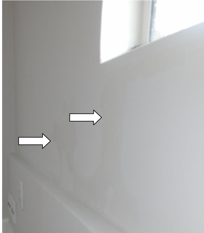
Figura 57 – Infiltração abaixo dos vértices inferiores das janelas
