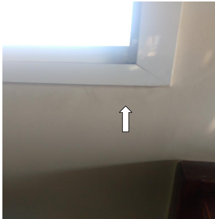
Figura 24 – Bolhas na pintura interna
