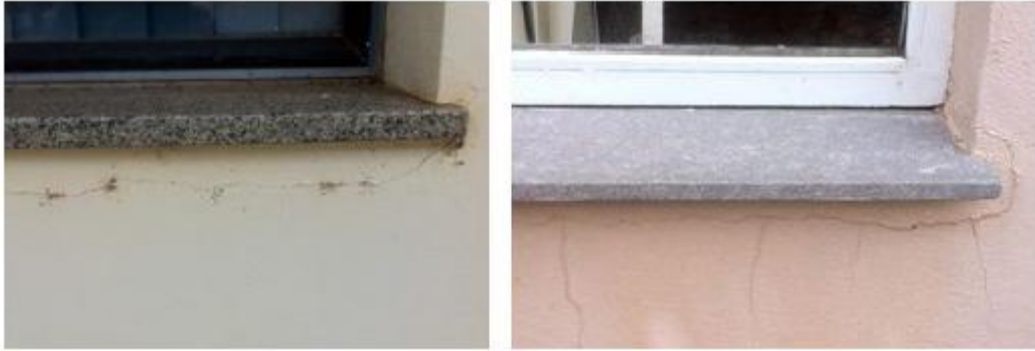
Figura 14 – Configuração típica de fissura horizontal sobre peitoril
