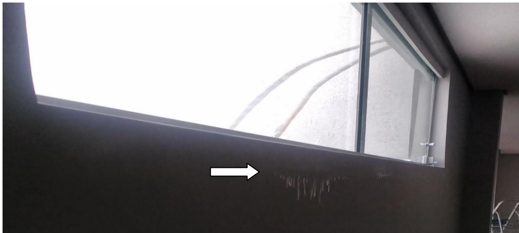
Figura 55 – Infiltração abaixo da janela
