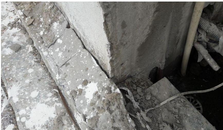
Figura 49 – Falha na fixação do rufo à parede reparada, erroneamente, com argamassa
