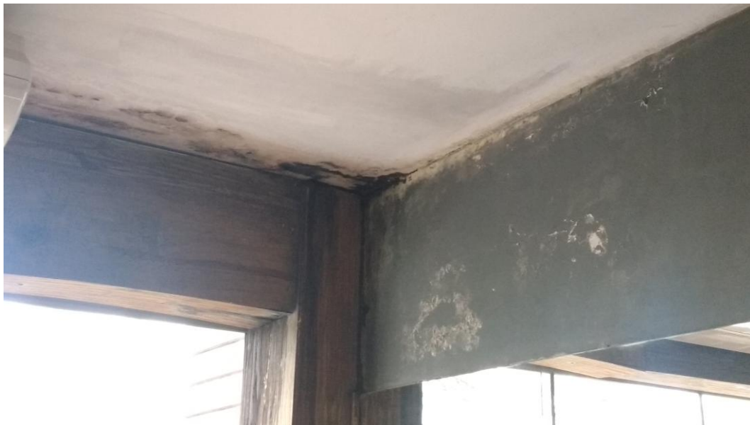
Figura 46 – Manifestações patológicas devido a entrada de água da chuva no 2º pavimento
