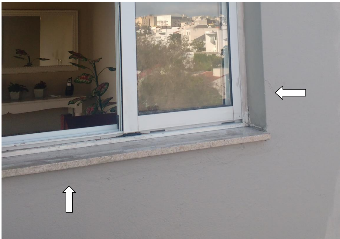
Figura 23 – Fissuras interface peitoril/alvenaria
