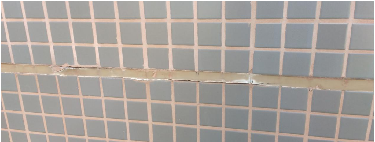
Figura 35 – Fina camada de selante desgastado
