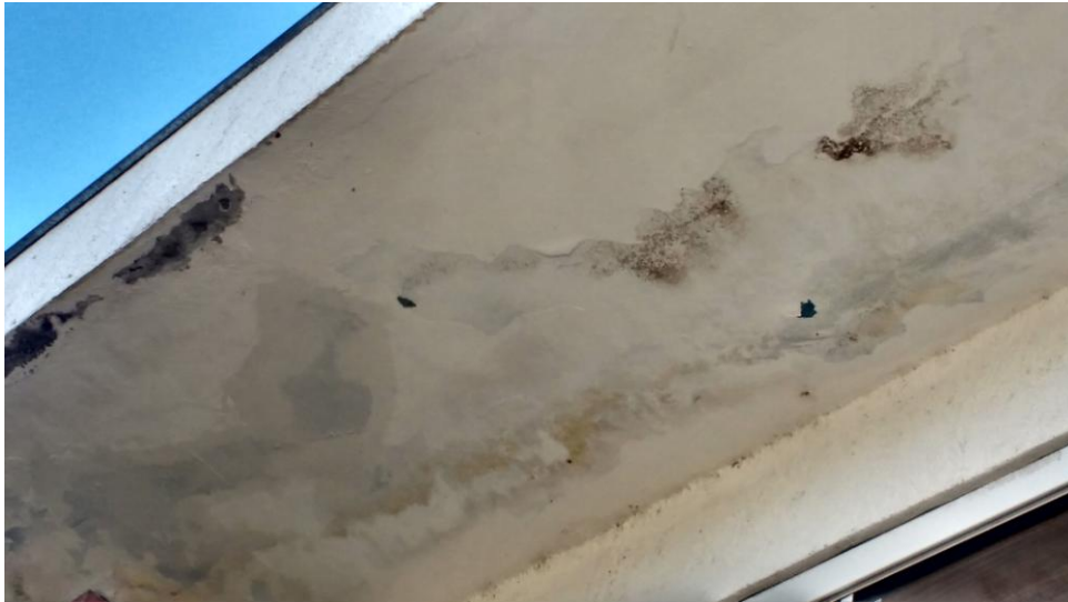
Figura 51 – Manchas e bolores em laje
