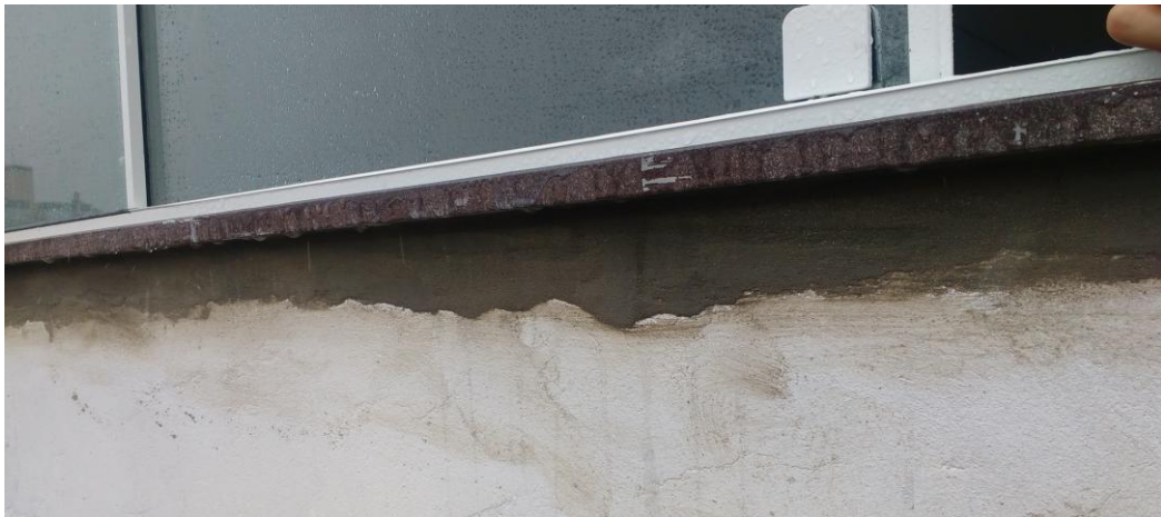
Figura 56 – Assentamento de peitoril desprotegido
