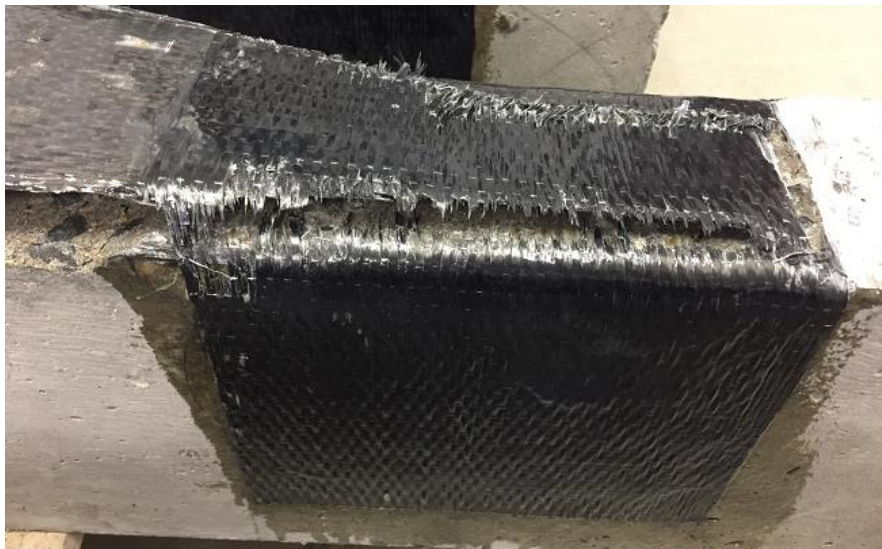
Figura 29 – Detalhe do rompimento do laço em “U” após o escorregamento ( slip off ) do reforço
