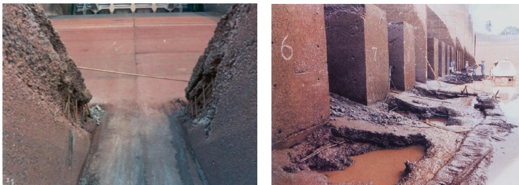
Figura 2. - Erosão no pé da barragem de Porto Colômbia, MG, causada por cavitação devido a altas velocidades do escoamento. (fonte: ELETROBRAS FURNAS)
