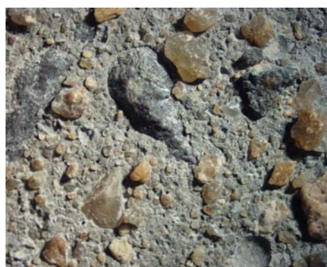
Figura 5.19 – Concreto 45 MPa (fcj) com agregado exposto após lavagem com hidrojateamento – ampliação de 7,6 X
