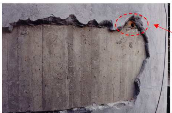
Figura 1.1 – Descolamento somente na parte aplicada sobre a estrutura de concreto; o revestimento aplicado sobre a alvenaria mostrou-se bem aderido (ver detalhe) – (CARASEK et al., 2005)
