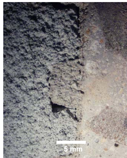
Figura 6.77 – Interface concreto 25 MPa c/ desmoldante, lav. quente, ch ind, Estudo Preliminar – ampliação 6,7x
