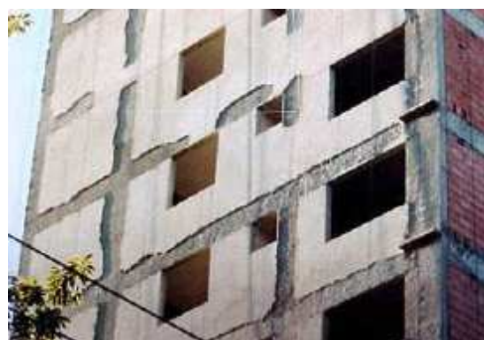
Figura 1.3 – Obra com descolamento do revestimento na estrutura de concreto (Comunidade da Construção, 2005)
