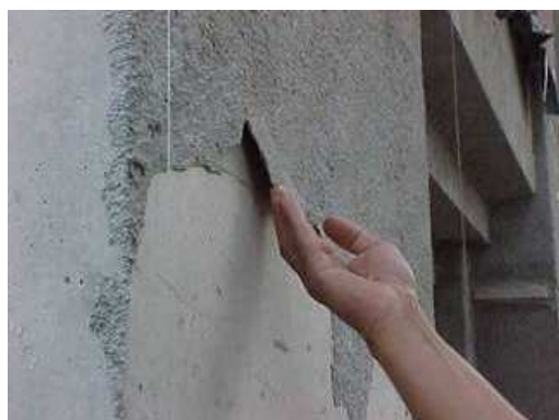
Figura 1.2 – Descolamento de chapisco convencional em estrutura de concreto (Comunidade da Construção, 2005)
