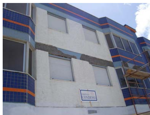
Figura 1.4 – Descolamento do revestimento nas vigas - Tramandaí/RS
