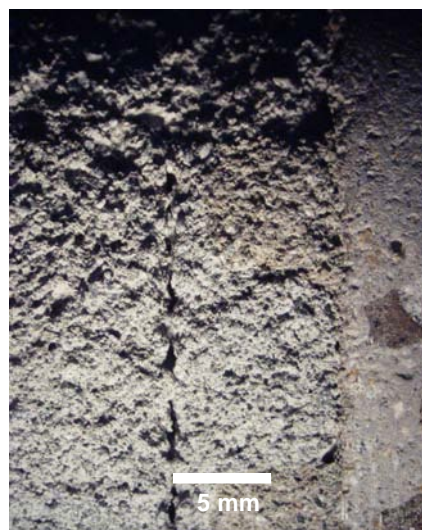
Figura 6.81 – Interface concreto 35 MPa – com desmoldante lavado quente, chapisco industrializado – ampliação 6,7x
