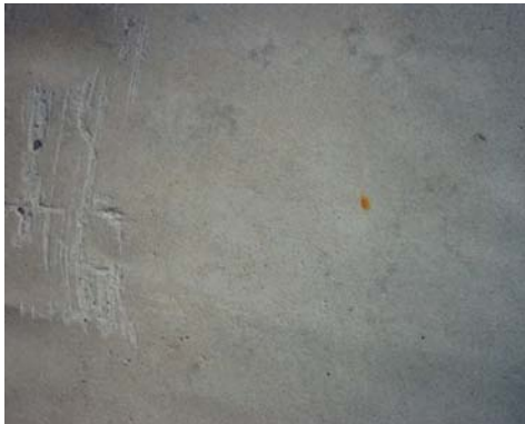
Figura 5.6 – Superfície do concreto 25 MPa (fcj) antes da lavagem – ampliação de 7,6X
