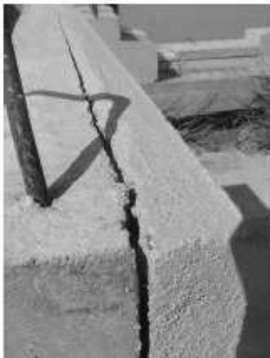
Figura 3.18 – Descolamento em placa, similar ao “efeito parede” na interface chapisco/concreto (SILVA, 2004).
