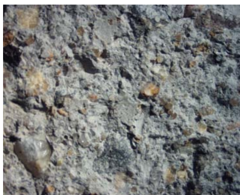
Figura 5.13 – Aspecto final da superfície do concreto 35 MPa (fcj) apicoada – ampliação de 7,6X
