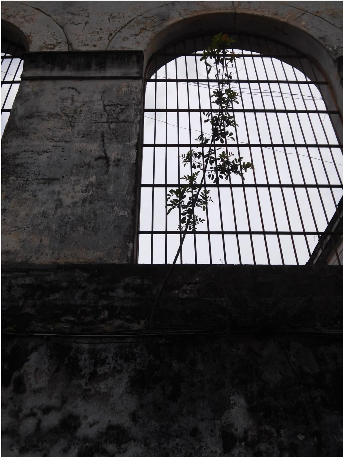
Figura 1: Frestas nos Muros 1
