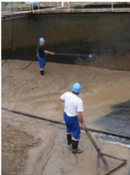
Figura 30- Coleta de lodo ao sulfato de alumínio (SA) no momento da limpeza do decantador 1 da ETA São Gabriel. (Fonte: A Autora, 2013)
