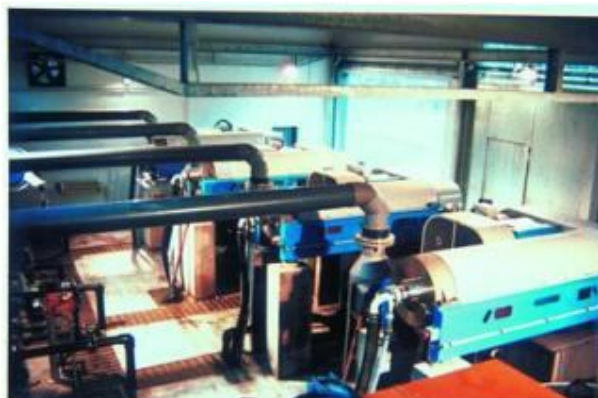
Figura 18- Conjunto de centrífugas: Instalação da Saint-Brieuc (Côtes-du-Nord) . (Fontes: DEGRÉMONT, 2007)
