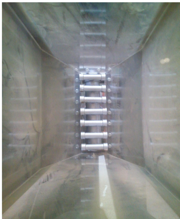
Figura C3 – Vista de cima do distribuidor de ar da planta de bancada.
