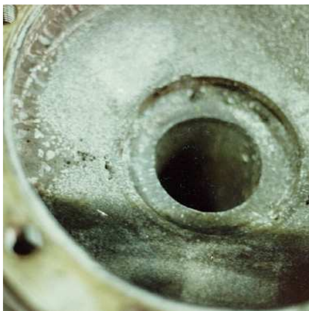
Fig. 8. Corrosão generalizada e grande presença de alvéolos na carcaça de uma bomba.
