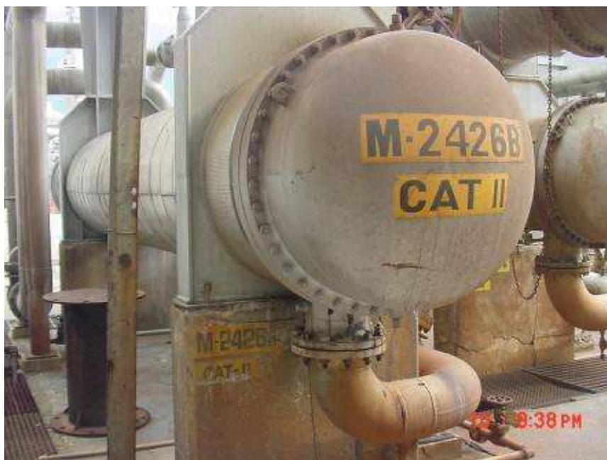
Fig. 5. Permutador de fundo da regeneradora.
