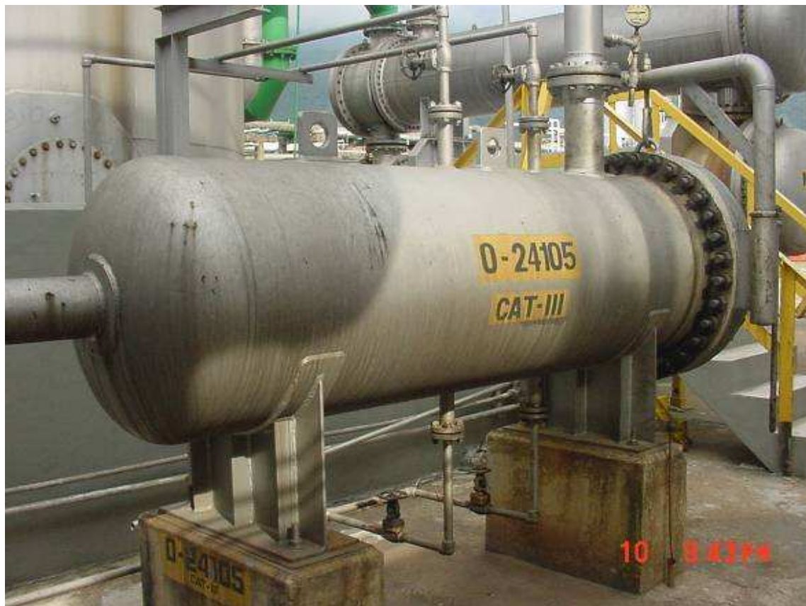
Fig. 3. Vaso para filtragem de DEA rica da linha de retorno à retificadora.
