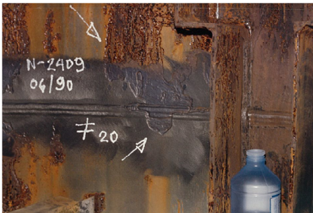
Fig. 15. Ataque por produto de degradação de DEA em solda do fundo da torre regeneradora. Fonte: Arquivos internos da IE/RPBC.
