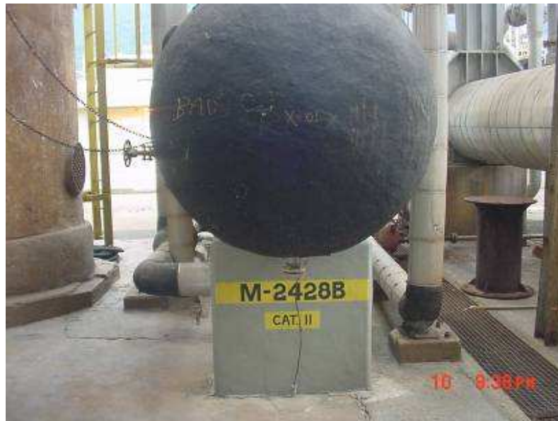
Fig. 4. Refervedor de fundo da torre regeneradora.
