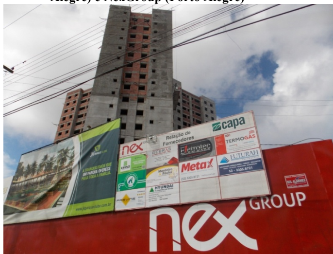
Figura 134. Residencial JK Parque Club. Incorporado pela joint venture entre Capa Engenharia (Porto Alegre) e NexGroup (Porto Alegre)
