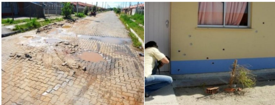
Figura 41. Precariedade e abandono no residencial Eldorado em Pelotas (RS)
