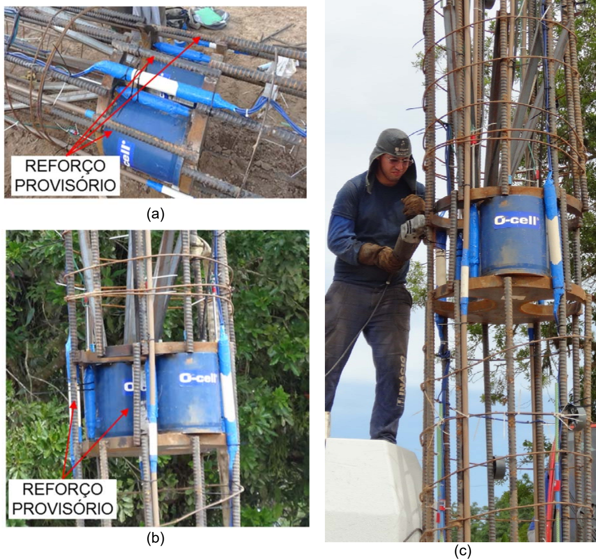
Figura 4-42 – Reforço provisório utilizado para içamento da armadura da ET-06: (a) detalhe durante instalação, (b) após içamento e (c) retirada dos reforços após içamento para instalação da armadura
