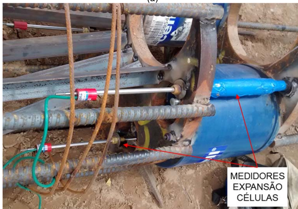
Figura 4-40 – Sensores instalados para monitoramento da expansão das células: (a) vista geral e (b) detalhe com o posicionamento acima das placas de regularização
