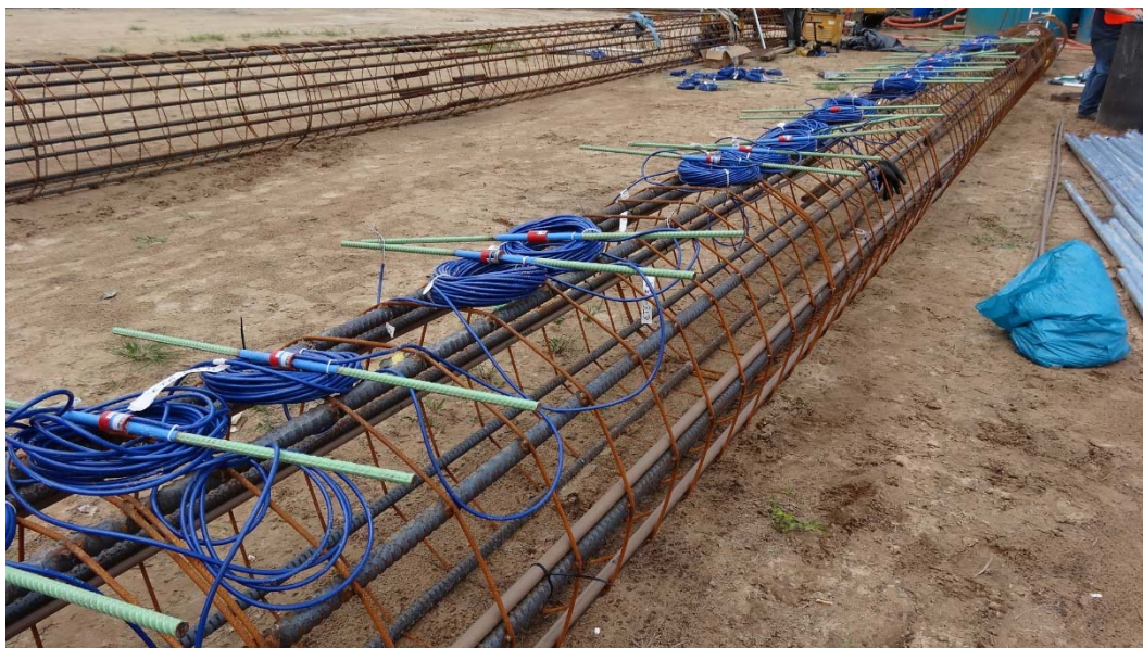
Figura 4-16 – Distribuição dos sensores previamente à sua fixação
