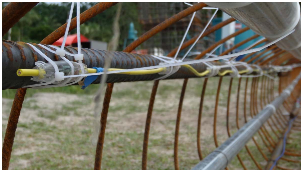
Figura 4-4 – Sensores TIP para monitoramento das variações de temperatura ao longo da cura do concreto na ET-05
